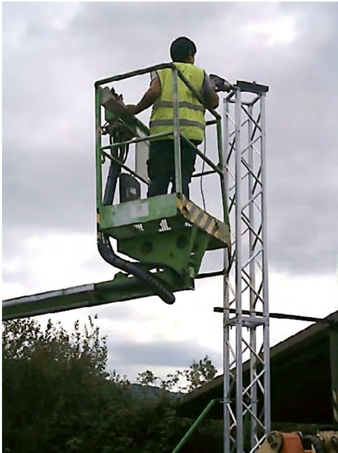
Figura 5.13. Distracción visual por el uso de un taladro
