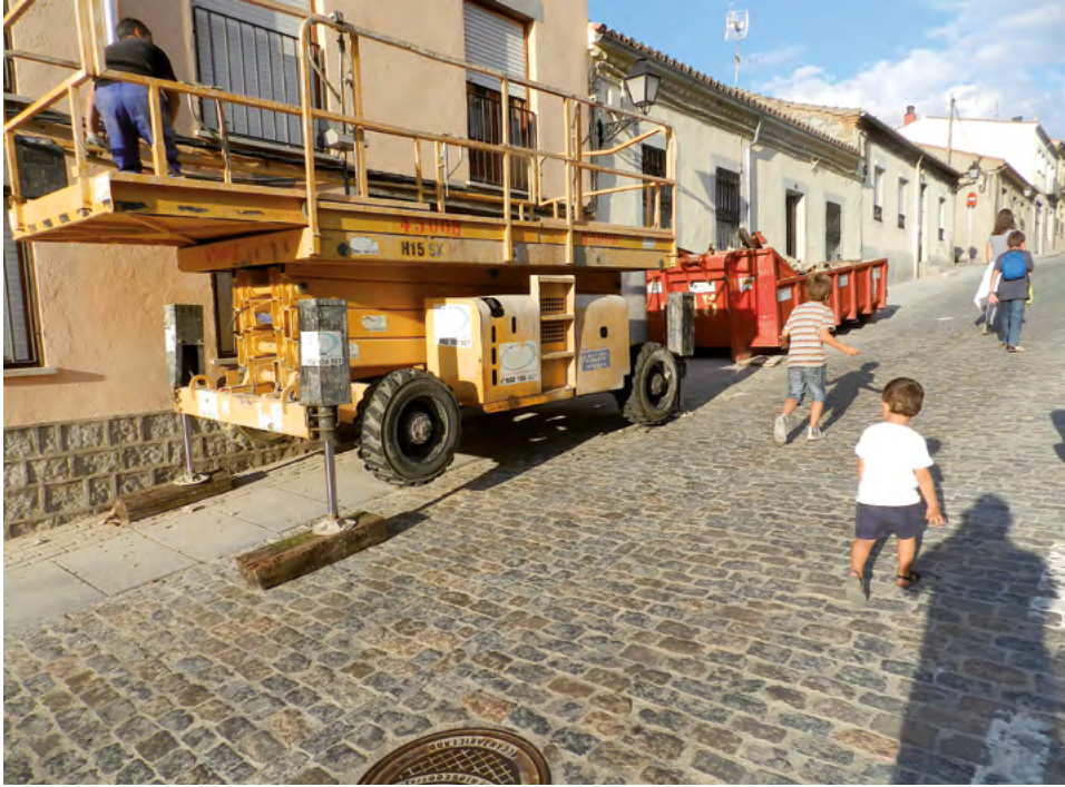
Figura 7.10. Supervisión incorrecta sobre el uso de una PEMP
