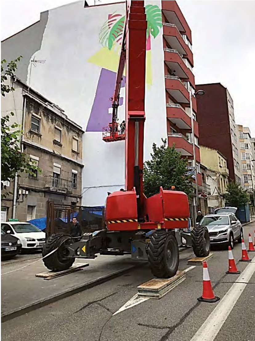
Figura 6.7. Uso de PEMP mal estabilizada
