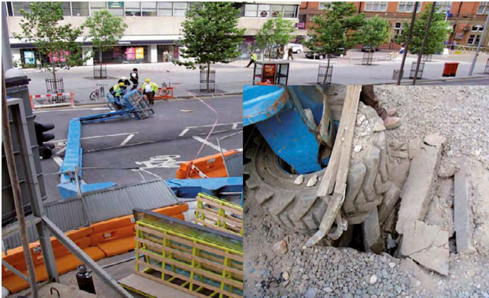
Figura 5.9. Accidente de la PEMP por falta de atención y supervisión
