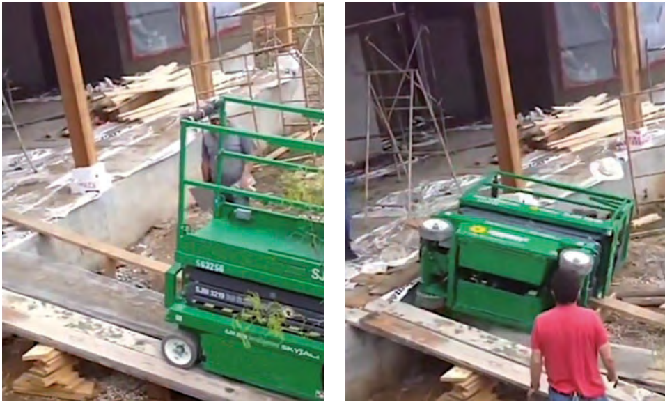
Figura 7.5. Uso de PEMP con supervisión incorrecta
