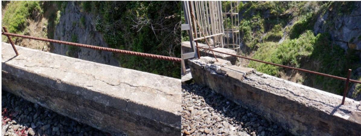
57. irudia. Pitzadurak eta luiziak balastoa babesteko horman
