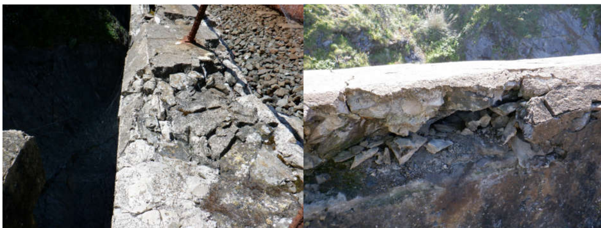
Figura 58. Coqueras y desprendimientos muro guardabalasto
