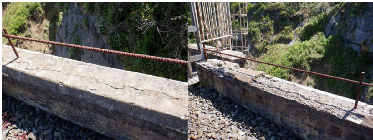
Figura 57. Fisuras y desprendimientos en muro guardabalasto
