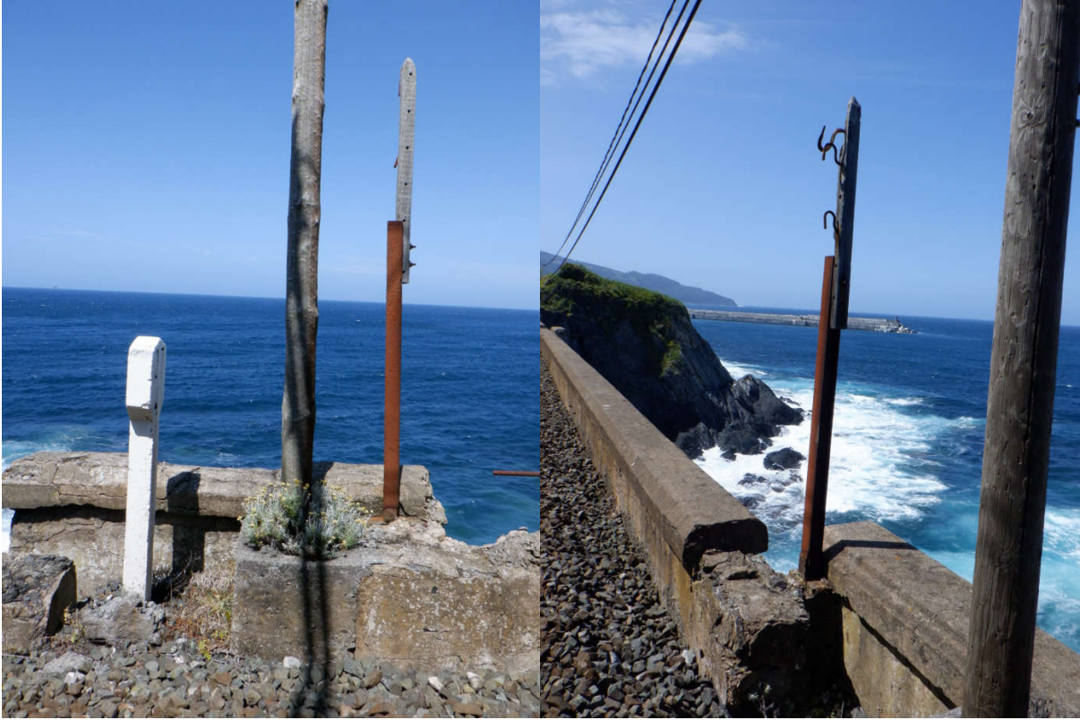
Figura 59. Elementos obsoletos existentes en superestructura
