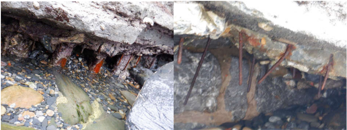
Figura 44. Micropilotes vistos en pila 7, junto a zócalo de cimentación y barras enresinadas en 2004
