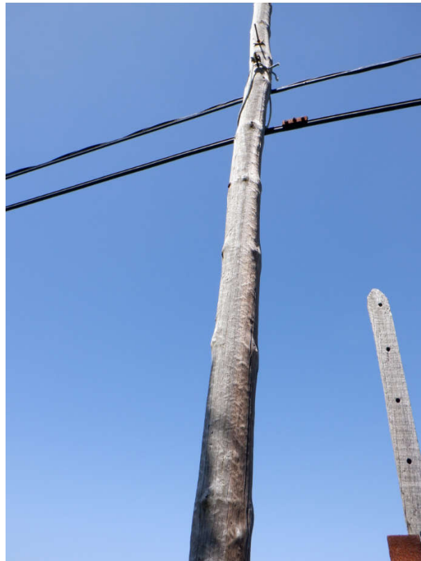
Figura 60. Poste de comunicaciones
