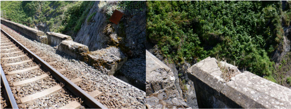
Figura 56. Muro guardabalasto desprendido
