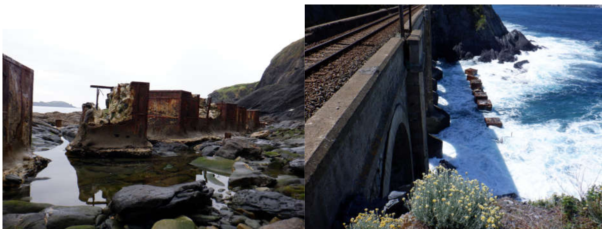
Figura 62. Aspecto de bloques frente al oleaje Figura 63. Rebase de bloques por el oleaje
