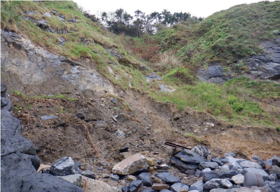
Figura 31. Erosiones localizadas en el pie de la ladera.
