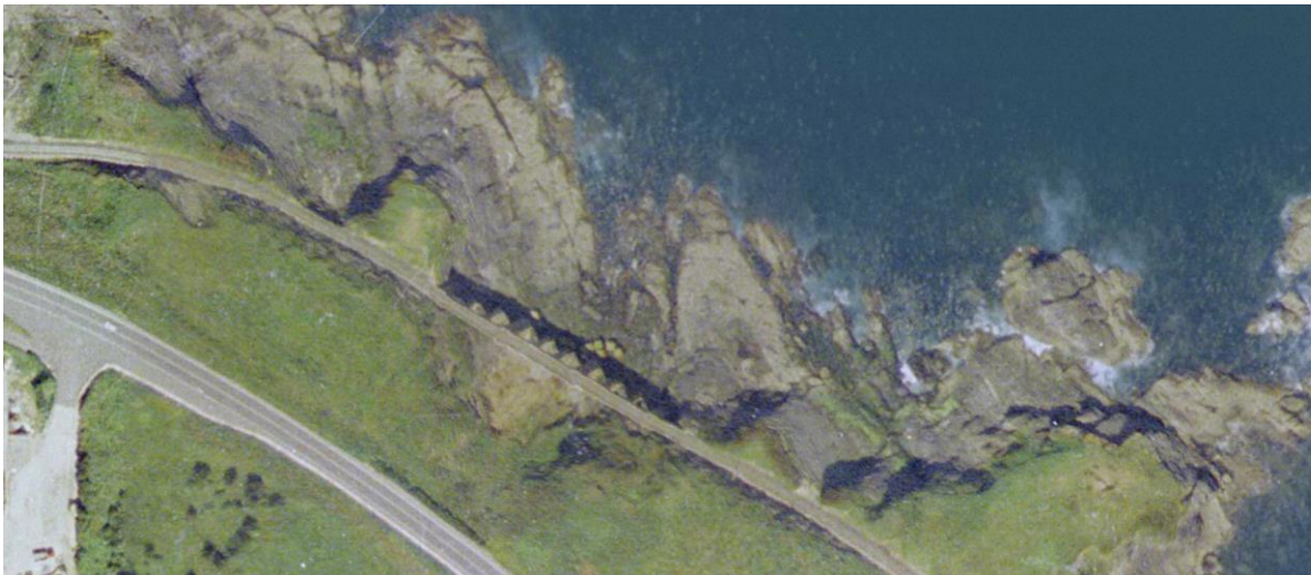
1995. Bloques de protección desplazados por la acción del oleaje.
