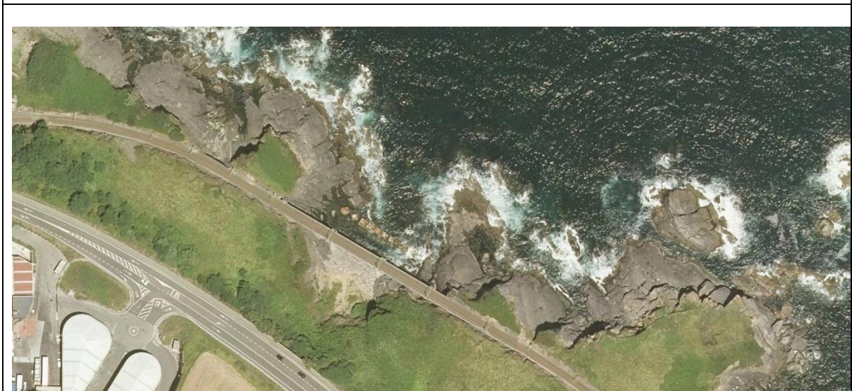
2016. Bloques de protección anclados al sustrato rocoso, pero con signos evidentes de deterioro. Se observa menor vegetación en la parte inferior de la ladera posiblemente causada por la incidencia de los temporales del año 2014.
