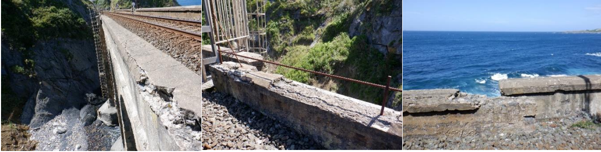
Figura 69. Rotura muretes guardabalastos
