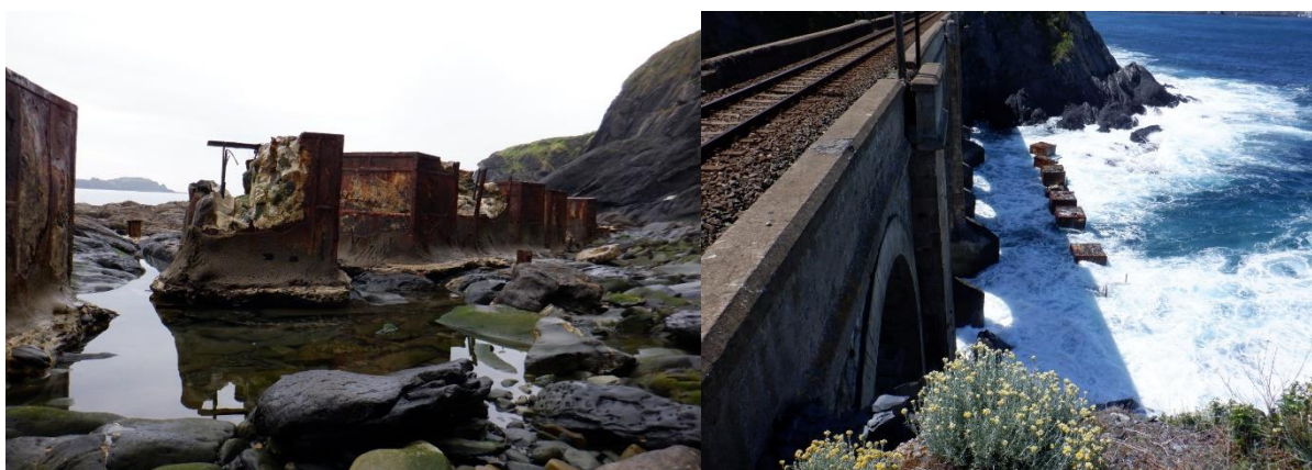
Figura 62. Aspecto de bloques frente al oleaje Figura 63. Rebase de bloques por el oleaje
