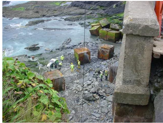
Figura 81. Polipasto eléctrico y cable de descuelgue
