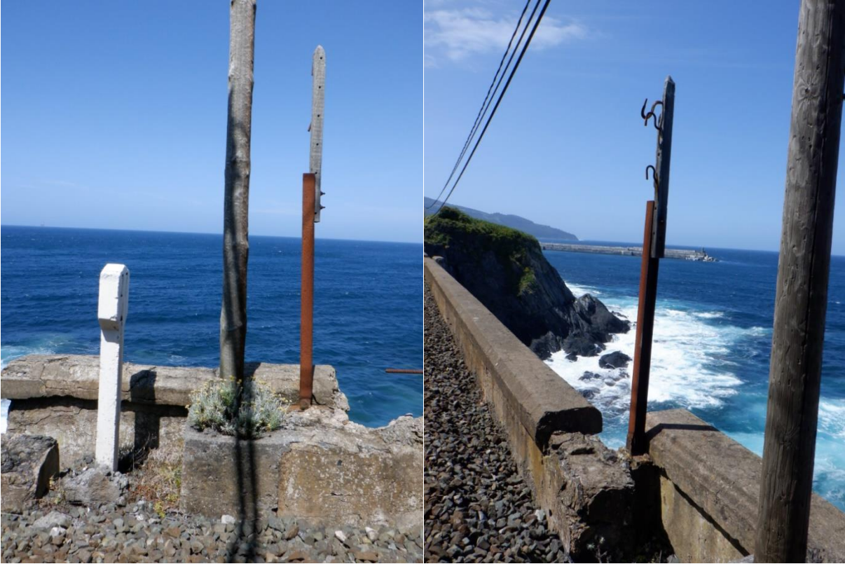
Figura 59. Elementos obsoletos existentes en superestructura
