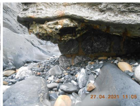
Figura 68. Descalce cimentación pila 7
