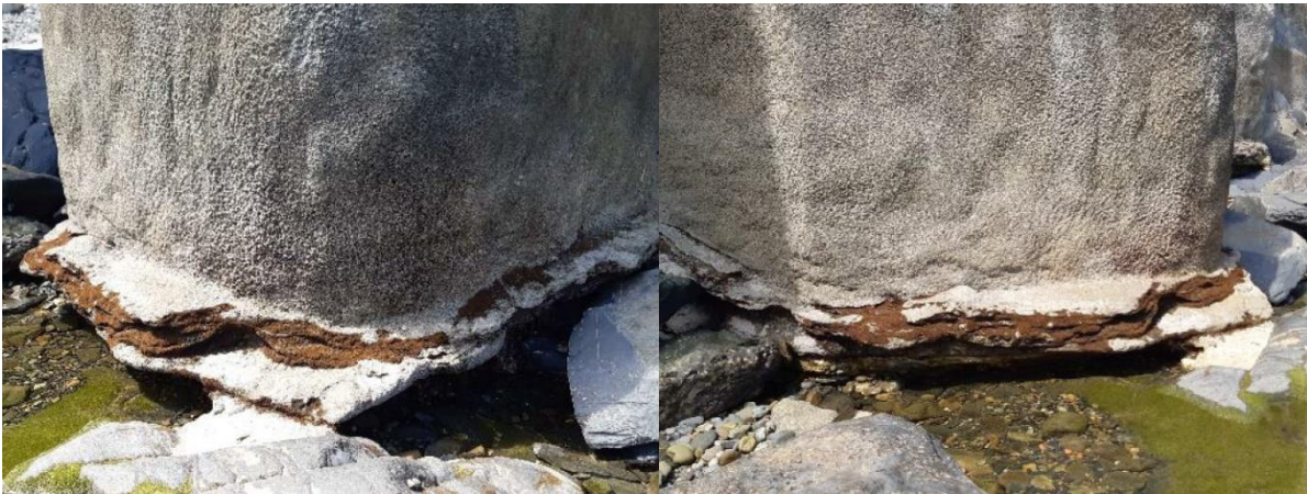
Figura 74. Socavaciones de menor entidad
