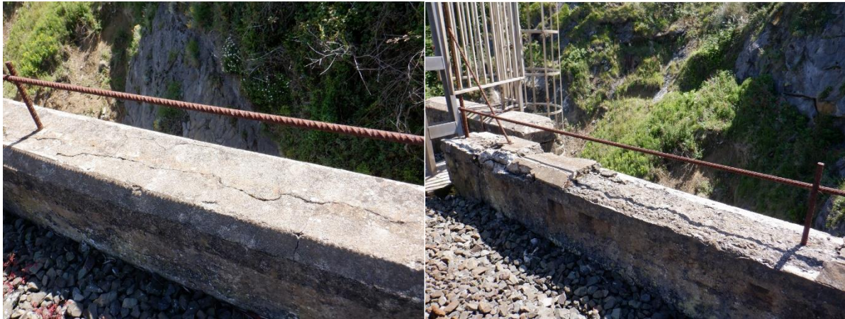
Figura 57. Fisuras y desprendimientos en muro guardabalasto
