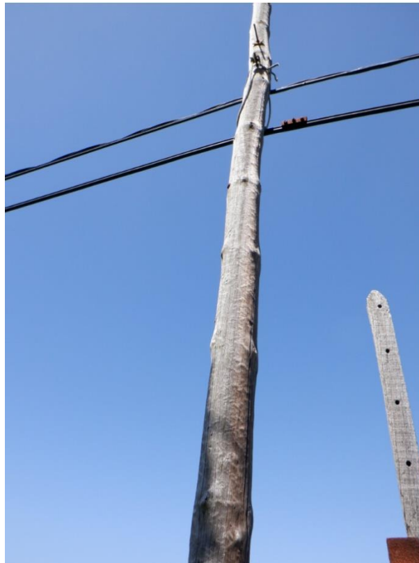
Figura 60. Poste de comunicaciones
