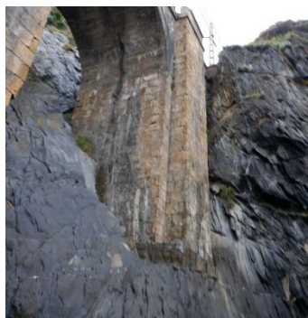
Figura 66. Erosión del sustrato rocoso con el tiempo bajo cimentación E2
