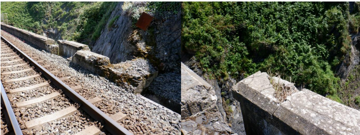
Figura 56. Muro guardabalasto desprendido
