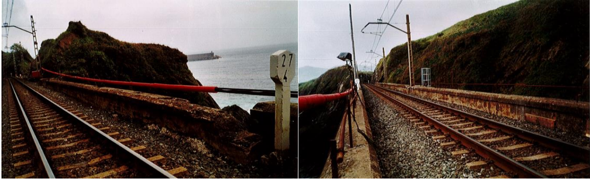
Figura 85. Canalización servicios de comunicación afectados
