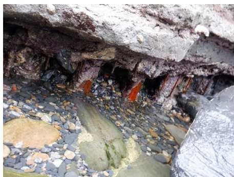
Figura 67. Descalce zona micros pila 7
