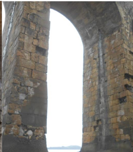
Figura 48. Flujo de calcificación, así como boquilla de drenaje
