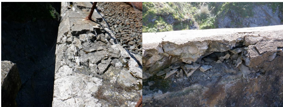
Figura 58. Coqueras y desprendimientos muro guardabalasto
