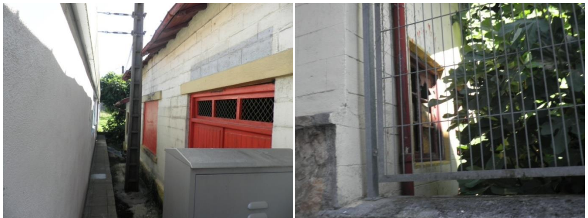
Fotos 16 y 17. Dos imágenes del edificio de almacén ya demolido. En la imagen de la derecha se puede apreciar el deterioro de la edificación auxiliar, a modo de caseta, anexa al edificio del almacén citado y también ya demolida.
