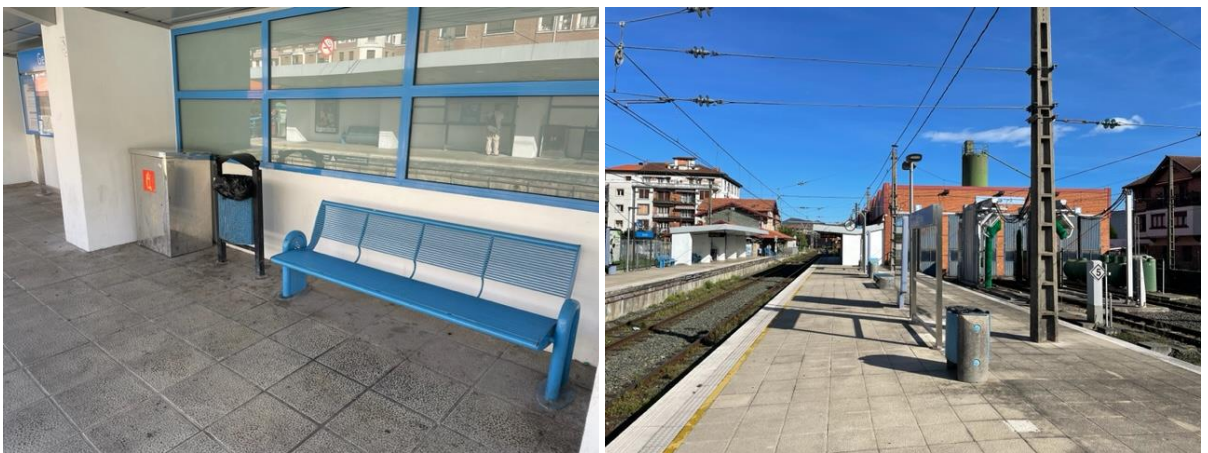
Fotos 36 y 37. Imágenes de mobiliario y señalética existente en marquesinas y andenes actuales. En la imagen de la derecha se observa el cableado grapado por frente de andén en el andén Oeste sentido Bermeo.
