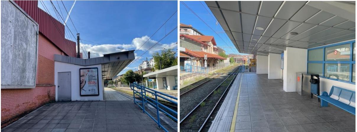
Fotos 34 y 35. Vista de la marquesina del andén sentido Amorebieta-Bilbao en ambas imágenes. En la imagen de la izquierda se observa la puerta de acceso al espacio existente entre la propia marquesina y edificio de cocheras, no apreciándose uso aparente del mismo. En ese espacio se aloja el poste de pórtico de catenaria que se aprecia en la imagen. La imagen de la izquierda está tomada en sentido de circulación Amorebieta-Bilbao y la de la derecha en sentido de circulación Bermeo.
