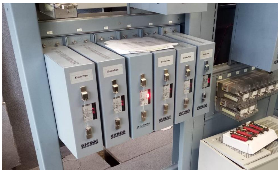
Figura: Bastidor con circuitos de vía en el enclavamiento
