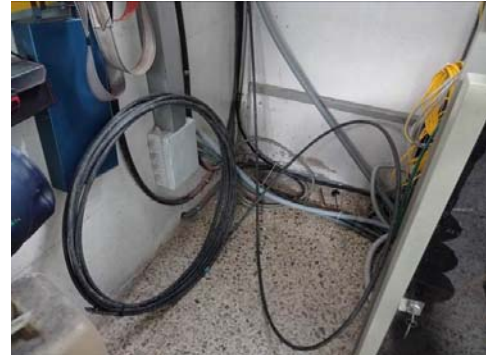
Cableado de la zona de oficina
