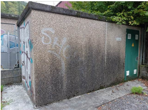
Foto 3. Aspecto del centro C.
