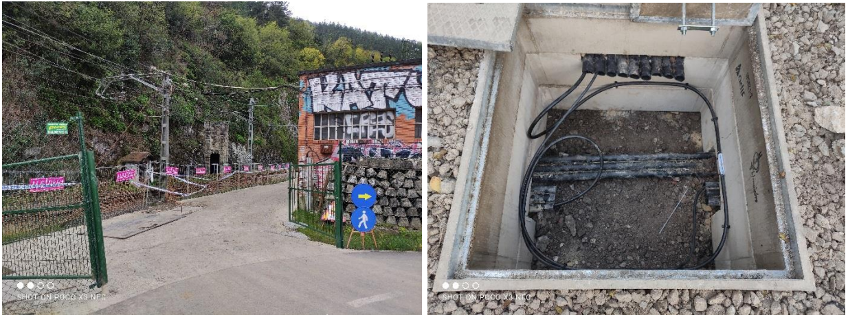
Fotografía 2. Localización e interior de arqueta de FO ejecutado en Obra de adecuación de accesos
