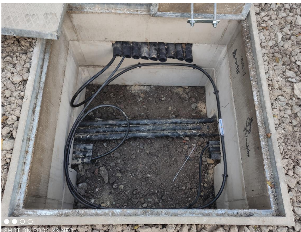
Fotografía 1. Arqueta de FO nueva
