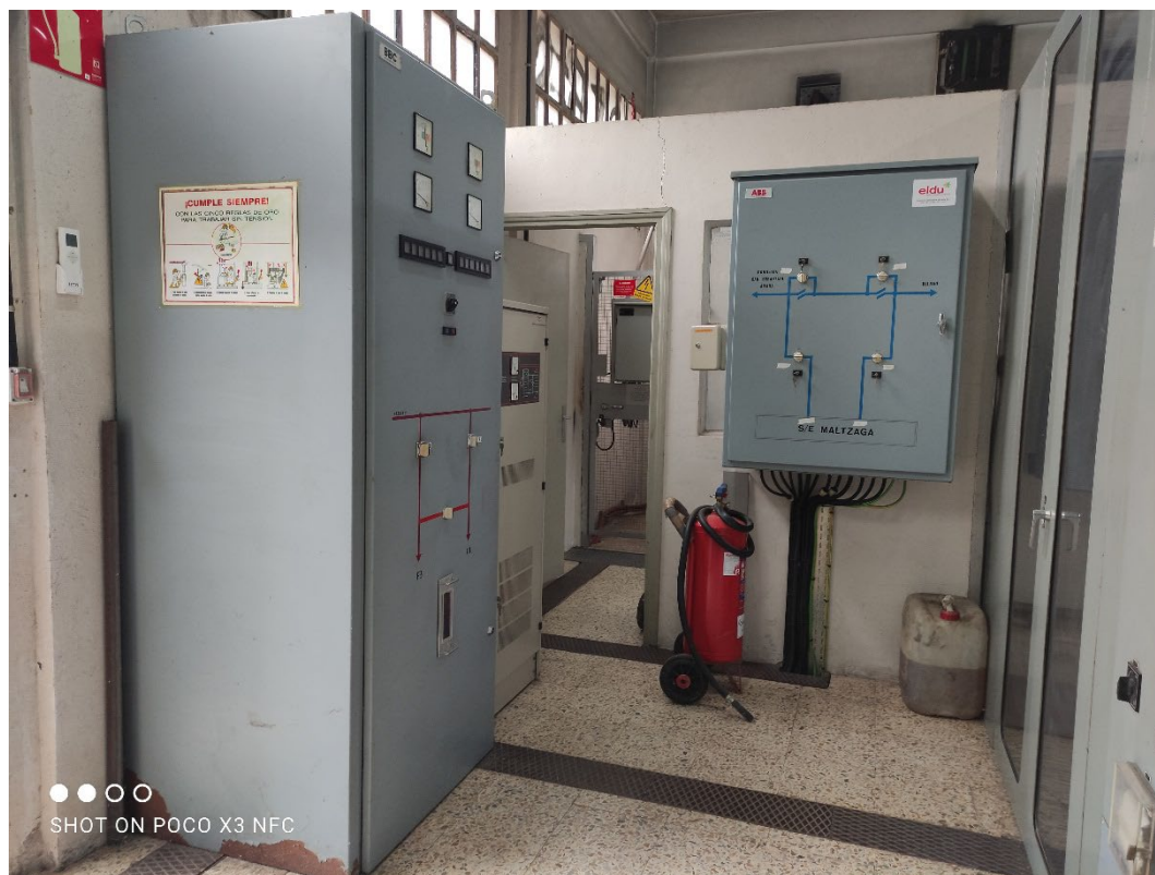
Fotografía 7. Equipamiento interior SET Maltzaga 1
