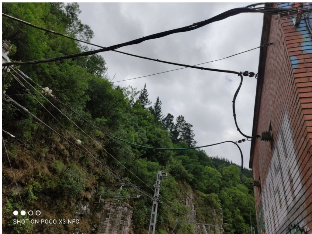
Fotografía 16. Salida feeders a catenaria
