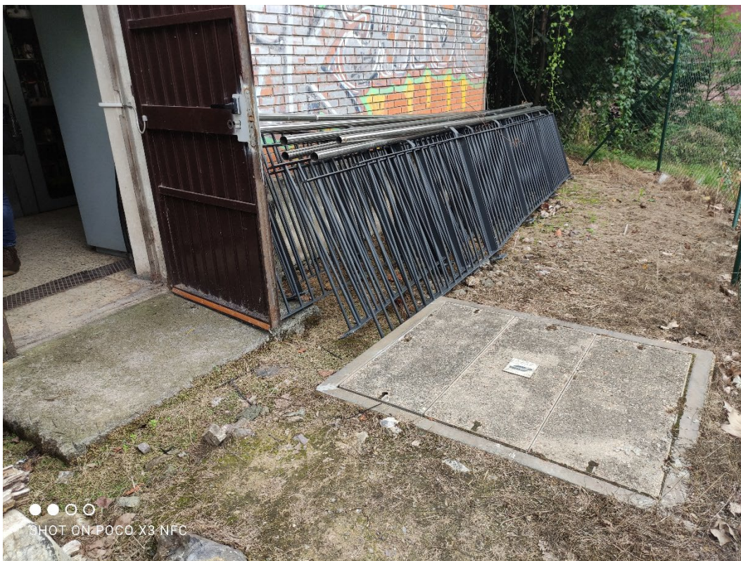
Fotografía 6. Arqueta FO junto a acceso principal SET Maltzaga
