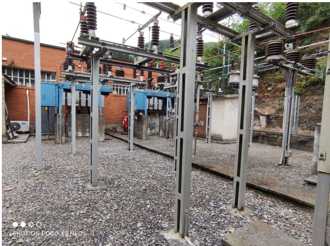
Fotografía 14. Parque exterior SET Maltzaga
