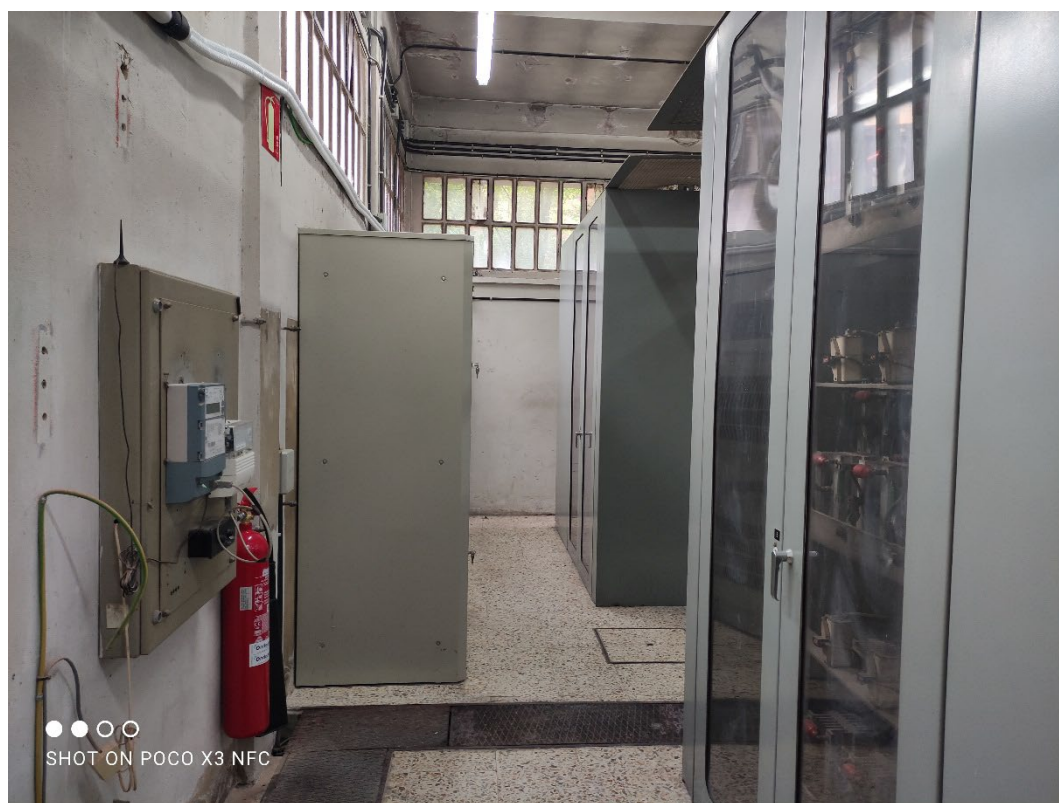
Fotografía 8. Equipamiento interior SET Maltzaga 2
