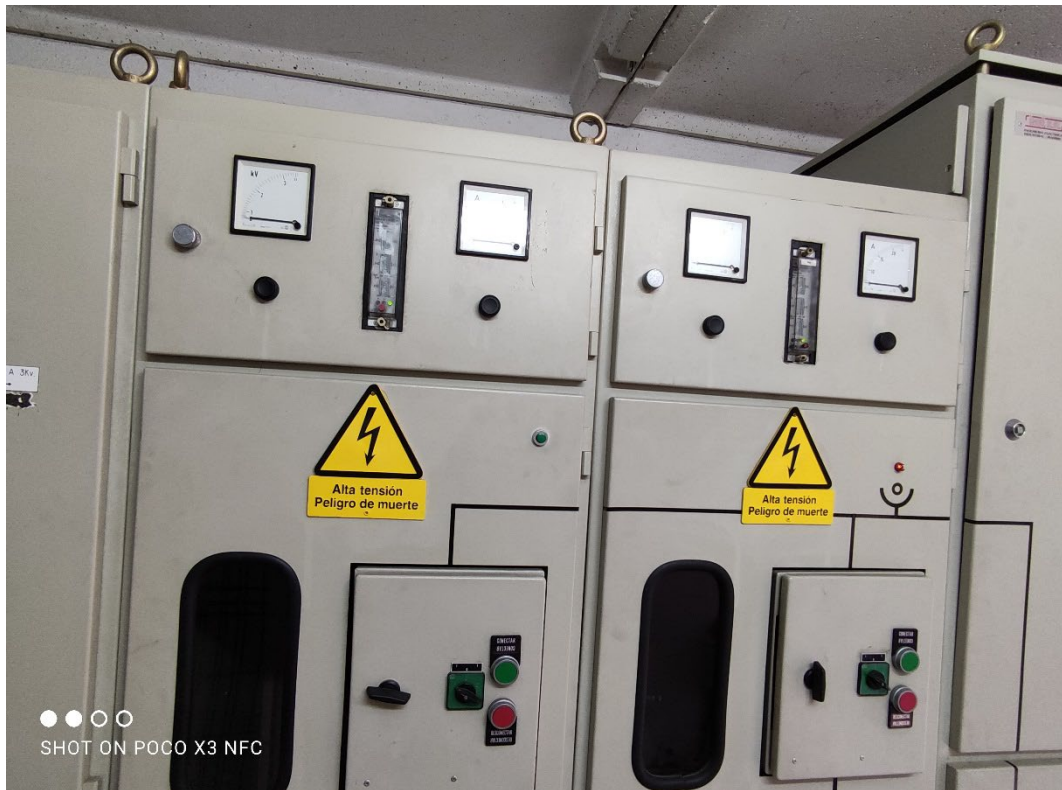
Fotografía 11. Celdas CC en interior edificio SET Maltzaga
