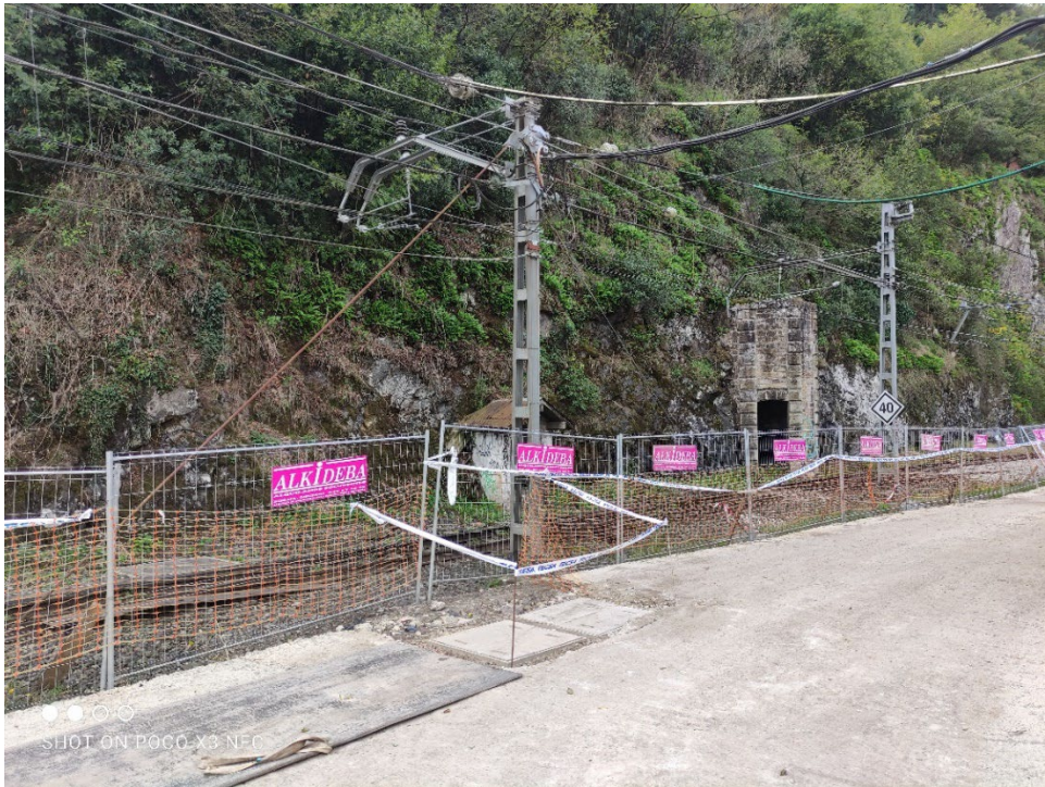
Fotografía 17. Arqueta doble de F.O.
