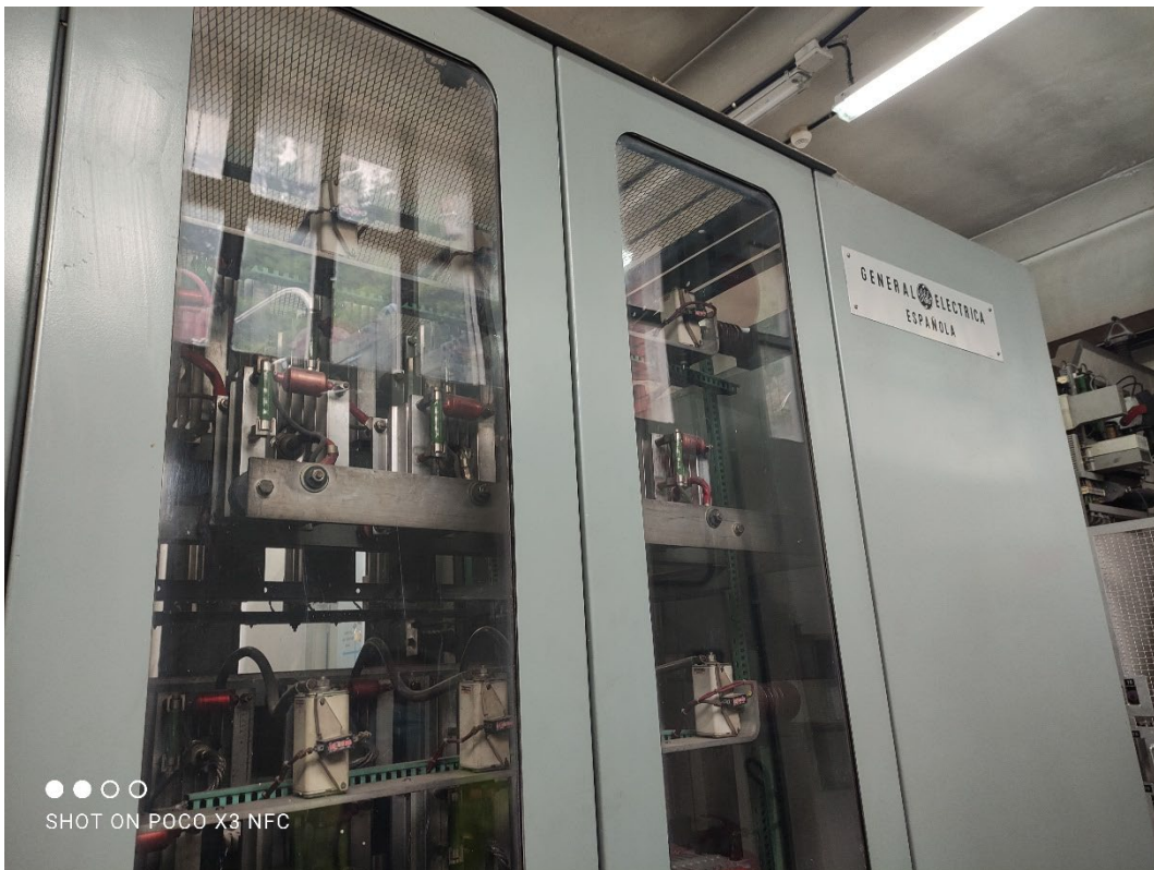
Fotografía 10. Grupo rectificador en interior edificio SET Maltzaga
