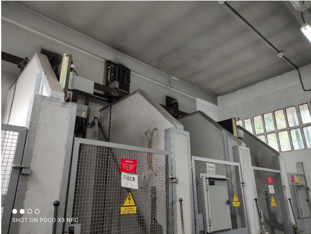
Fotografía 9. Zona feeders actuales en interior edificio SET Maltzaga
