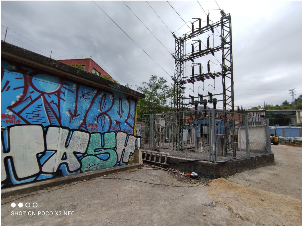
Fotografía 5. Acometida eléctrica actual SET Maltzaga en 30 kV, DC y caseta de enclavamiento
