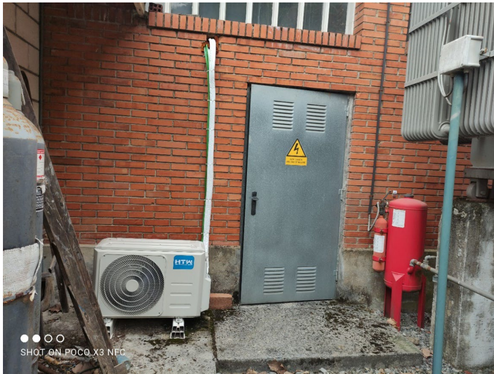
Fotografía 13. Acceso a parque exterior desde edificio SET Maltzaga
