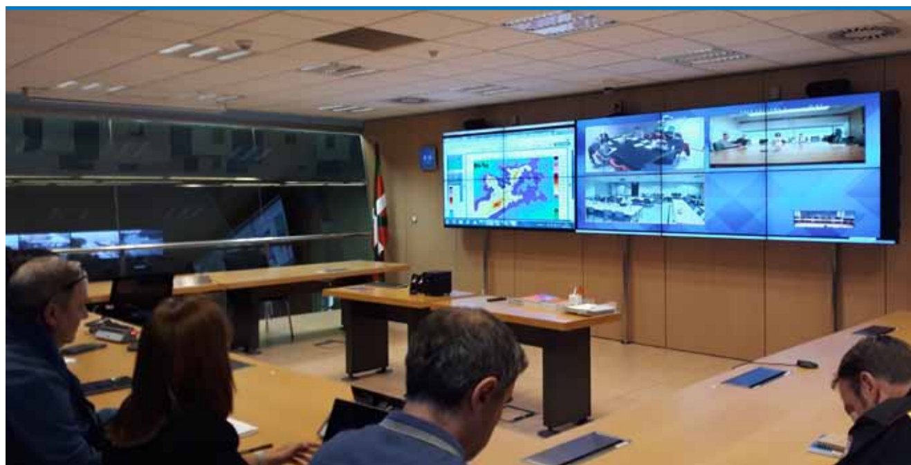
Videowall de la sala de crisis del Centro de Coordinación de Emergencias de Euskadi SOS Deiak.
