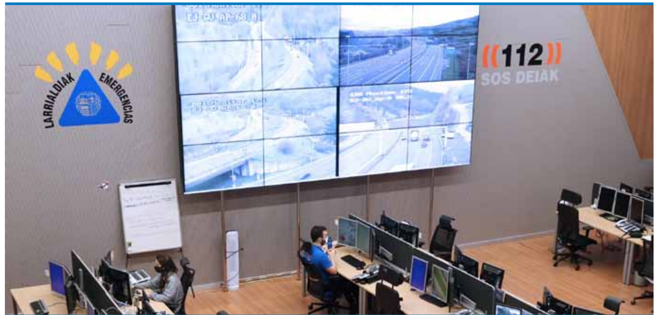
Videowall de la sala operativa del Centro de Coordinación de Emergencias de Euskadi SOS Deiak
