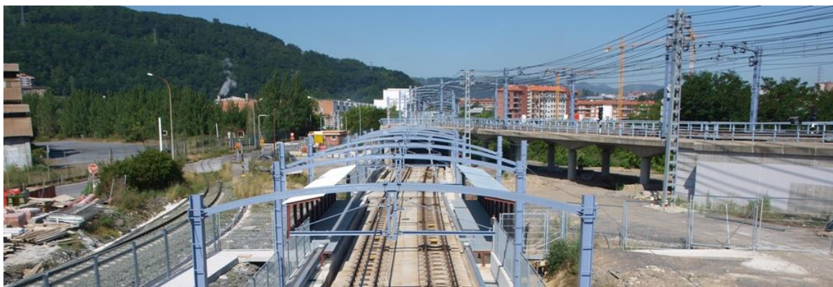
Foto 6. Pórticos de electrificación del tramo Etxebarri – Ariz - Basauri.
