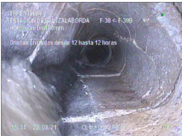
Fotografía: 3_3a, Nº Video: 0 2,9m, Grietas cruzadas desde 12 hasta 12 horas
