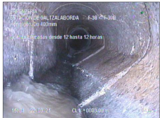
Fotografía: 3_3b, Nº Video: 0 2,9m, Grietas cruzadas desde 12 hasta 12 horas
