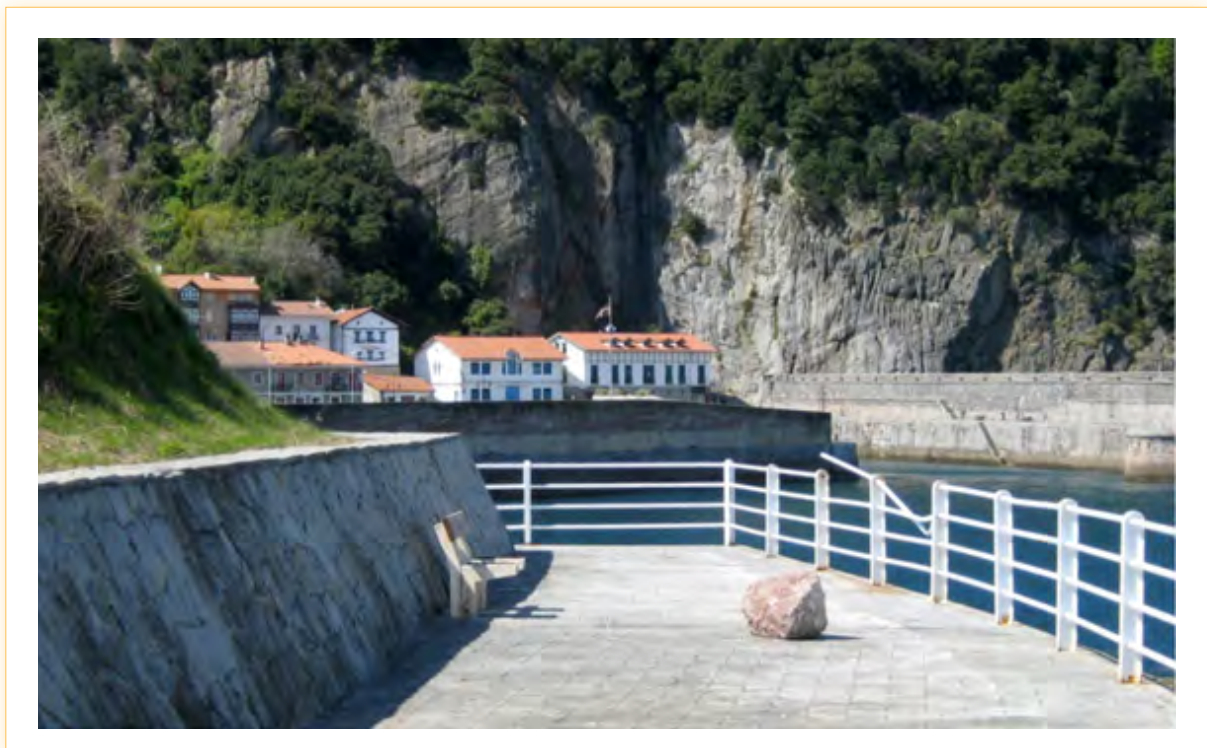
10. Irudia. Harrizko blokearen erorketa. Oinezkoentzat arriskurik ez dagoen leku batean barandan jo eta kaltetu du.
