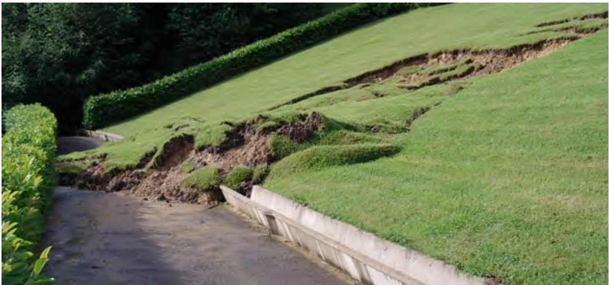
3. Irudia. Lur-irristatzea, drainatze-kanal bat eta bide bat itxi dituena.
