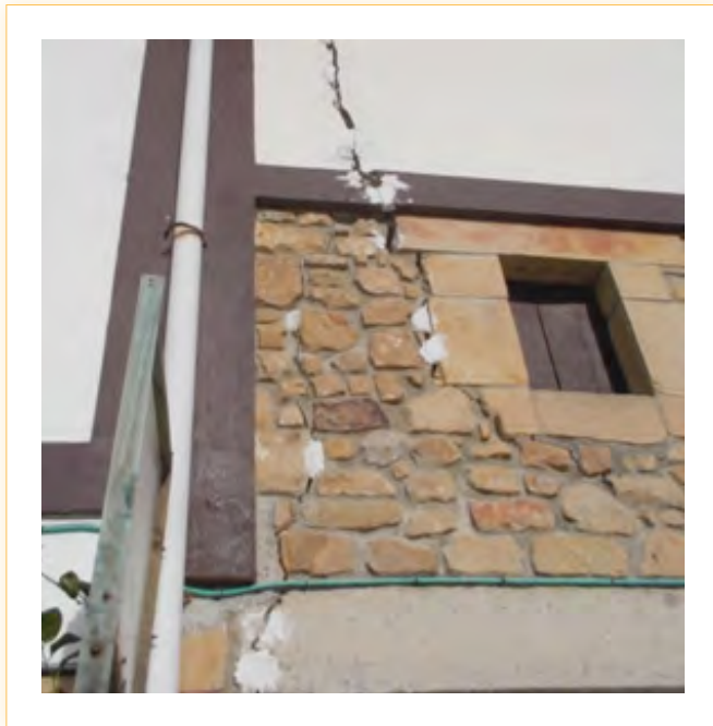
26. Irudia. Etxebizitza baten fatxadan konpondutako pitzadurak berriro ireki dira.
