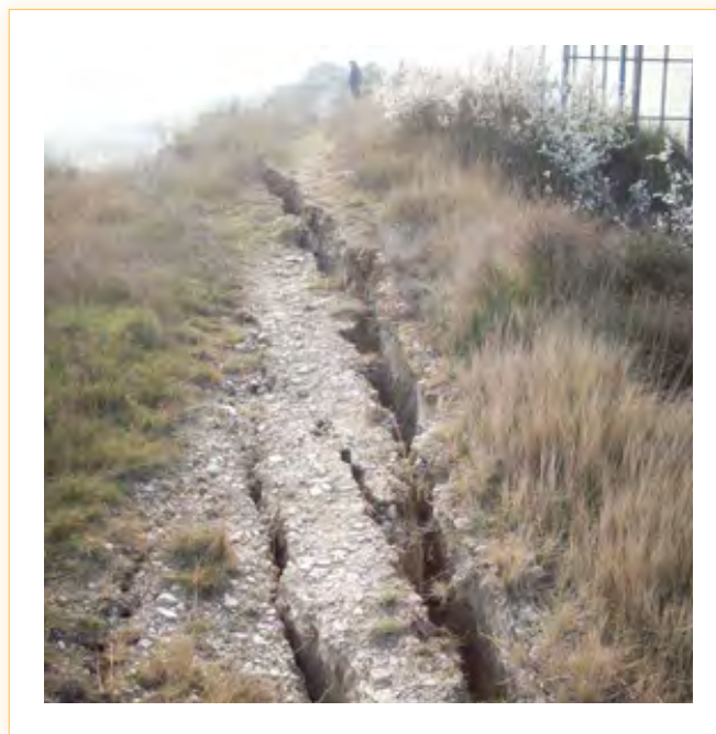
24. Irudia. Malkarra eta trakzio-arrailak hegala goiko aldean.
