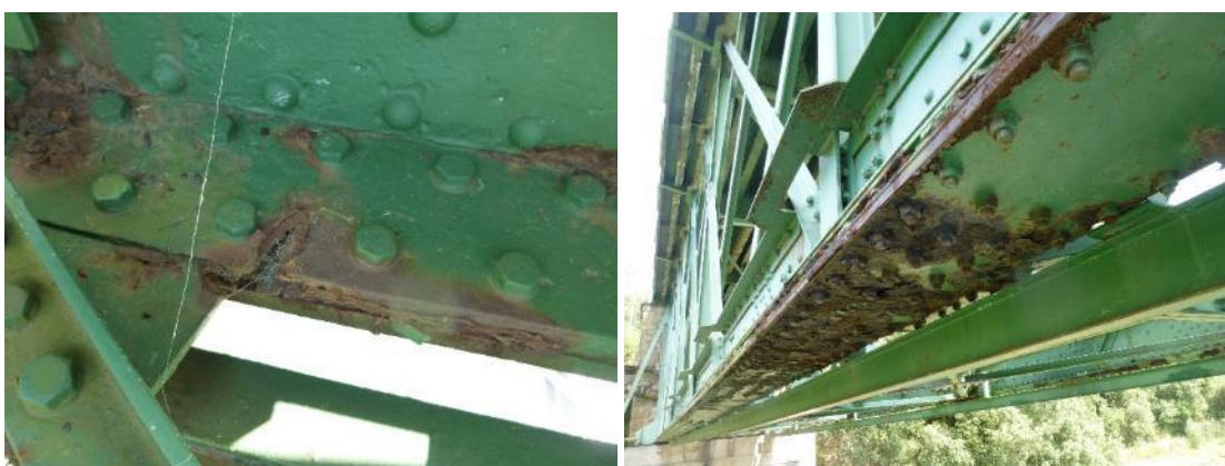
27. irudia. Ezkerrean, sekzio-galera handia 2. baoko 6. moduluan, ibaian gora dagoen beheko kordoiaren beheko hegalean. Eskuinean, korrosio orokortua ibaian behera dagoen beheko kordoiaren sendogarrian, 2. baoko 6. moduluan.
