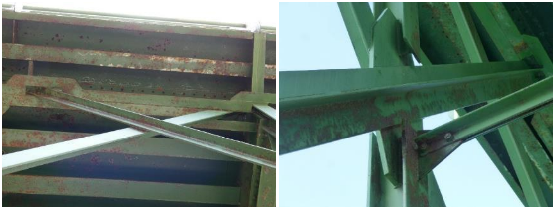
32. irudia. Gainazaleko korrosioa alboko saretetan. Ezkerraldean, 2. baoko 9. moduluaren goiko kordoia, ibaian behera. Eskuinaldean, 2. baoko 2. moduluaren kontradiagonala, ibaian behera.
