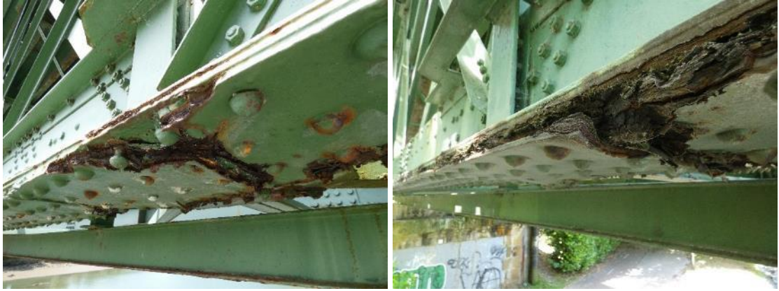
28. irudia. Korrosioaren ondoriozko sekzio-galera handiak beheko kordoiaren beheko hegalean. Ezkerraldean, 2. baako 9. modulua, ibaian gora; eskuinaldean, 1. baako 3. modulua, ibaian gora.
