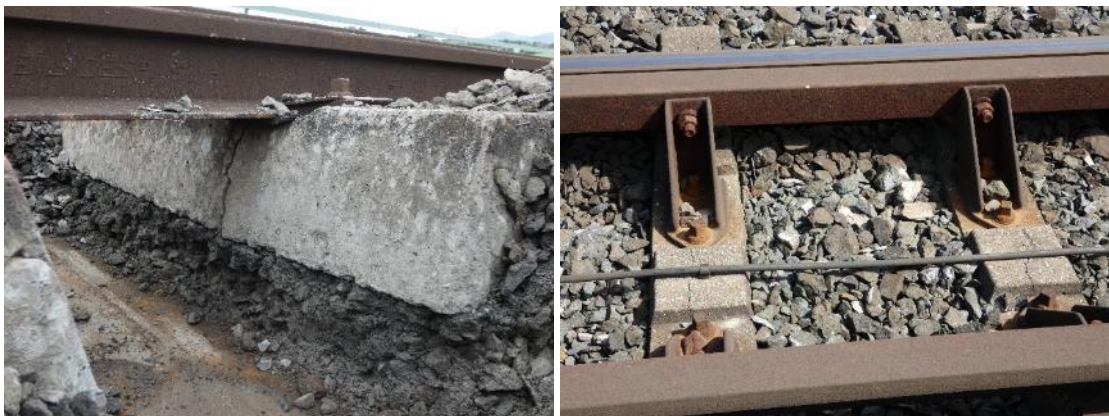
50. irudia. Nekeak eragindako pitzadurak hormigoizko trabesetan. Eskuinean, elementuaren sekzio-haustura, erreiarekin bat etorriz, eta, eskuinean, elementuaren beraren ardatzarekin lerrokatutako pitzadurak.
