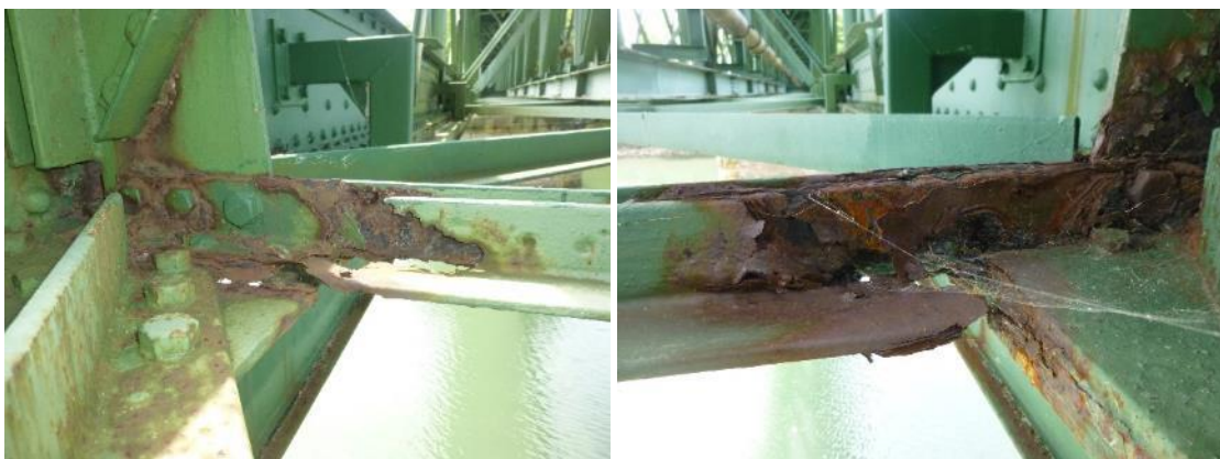
42. irudia. Beheko tiranteak, korrosioaren ondoriozko zuloekin beheko kordioarekiko lotunean, 2. baiko 7. moduluan.
