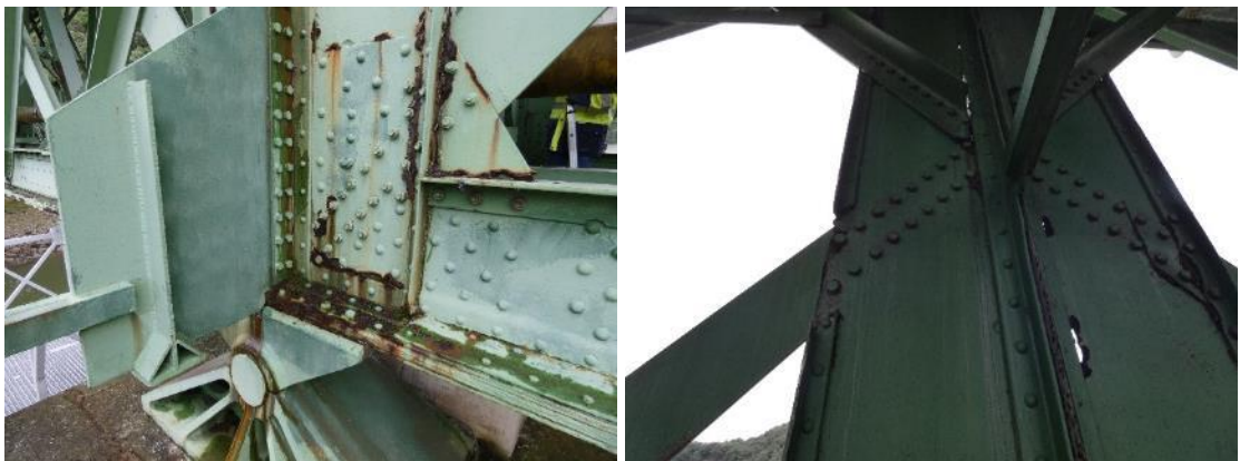
30. irudia. Korrosio handiak, xaflak zulatzerainokoak ere, 1. pilaren gaineko berme-muntagan, ibaian behera.
