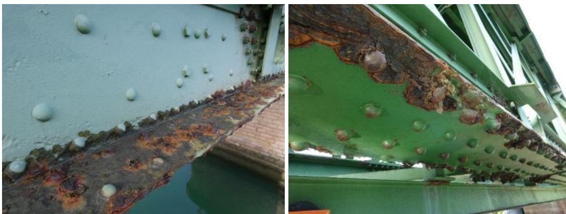
26. irudia. 2. baoko 3. moduluan, ibaian behera dagoen saretaren beheko kordoiaren sekzio-galera handiak dituzten korrosioak.
