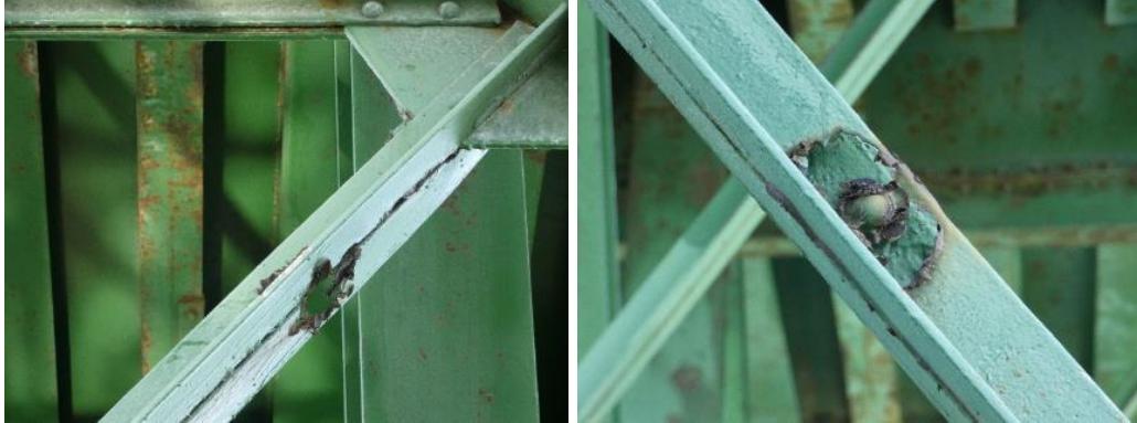
40. irudia. Goiko erdian korrosioak eragindako zuloak dituzten diagonalak. Ezkerrean, 2. baiko 4. modulua eta, eskuinean, 2. baiko 1. modulua.
