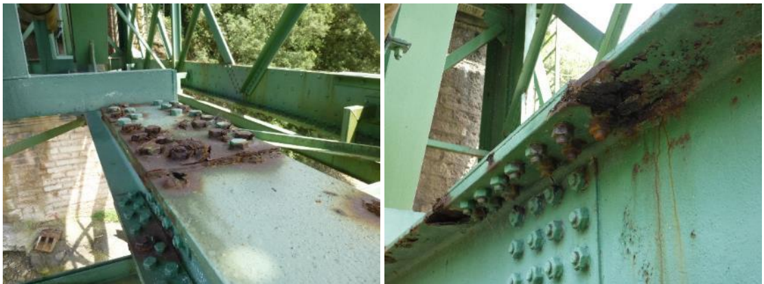
22. irudia. Korrosioak eragindako beheko kordioaren jarraitutasun-loturak. Ezkerraldean, 2. baoko 8. modulua eta, eskuinaldean, 2. baoko 9. modulua.
