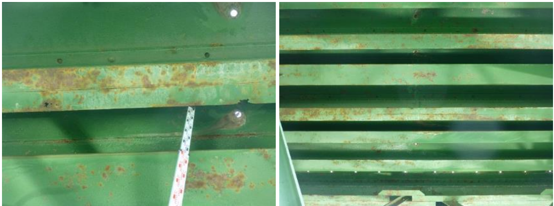
47. irudia. Gainazaleko korrosioak, zuloren bat ere bai, 2. baiko 6. moduluko lauza ortotropan.
