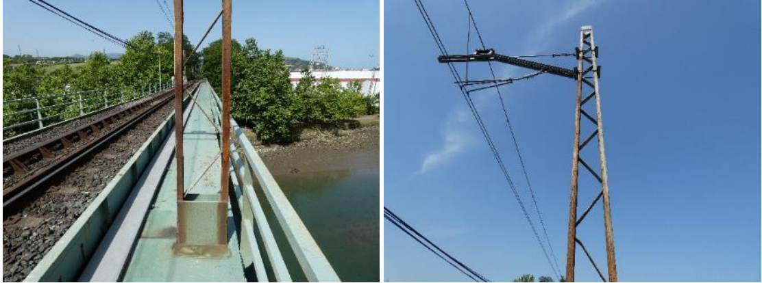
54. irudia. Zubiaren gainean dagoen katenariako zutoina, gainazaleko korrosioekin.
