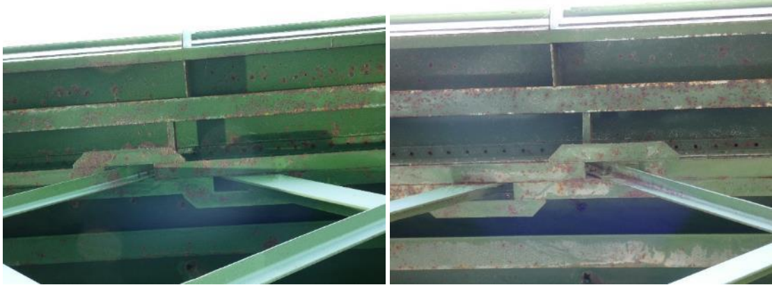
49. irudia. Gainazaleko korrosioak lauza ortotropoaren alboko zati irtenean. Ezkerrean, 2. baoko 3. modulua eta, eskuinean, 1. baoko 6. modulua.
