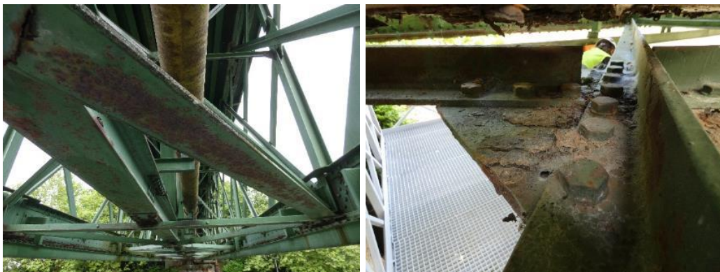
39. irudia. Sareta horizontaleko San Andresen gurutzea osatzen duten diagonalak, intentsitate txikiko gainazaleko korrosioekin. Ezkerrean, 1. baiko 8. modulua eta, eskuinean, 1. baiko 1. modulua.
