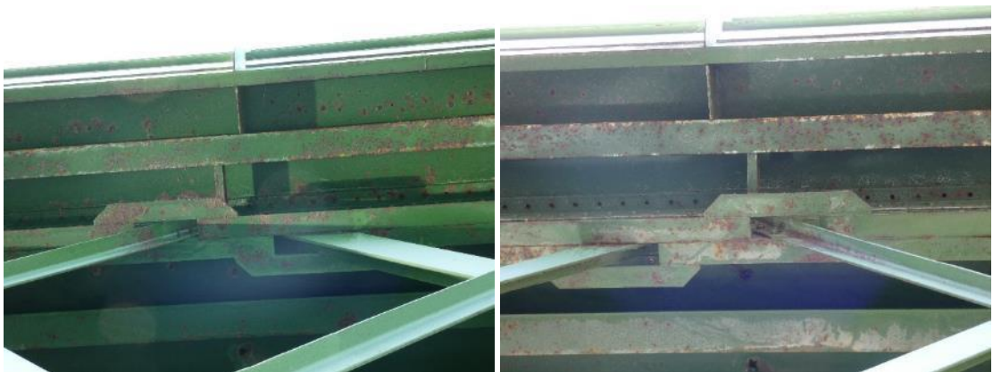
Figura 49. Corrosiones superficiales en la parte volada lateral de la losa ortótropa con corrosiones superficiales. Izquierda, módulo 3 del vano 2 y, derecha, módulo 6 del vano 1.
