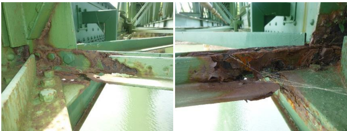
Figura 42. Tirantes inferiores con perforaciones debidas a la corrosión en la unión con el cordón inferior en el módulo 7 del vano 2.
