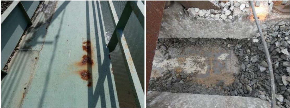
Figura 52. Izquierda, corrosiones puntuales en la chapa de piso del paseo de aguas arriba. Derecha, ligeras pátinas de corrosión en la chapa de piso bajo el balasto.
