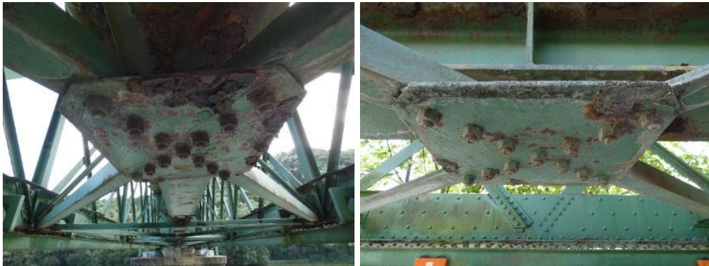
Figura 38. Cartela para el cruce de diagonales con corrosiones superficiales y acompañadas del algún paquete de hidróxido puntual. Izquierda, módulo 6 del vano 1 y, derecha, módulo 2 del vano 1.
