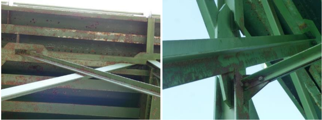
Figura 32. Corrosión superficial en celosías laterales. Izquierda, cordón superior del módulo 9 del vano 2 aguas abajo. Derecha, contradiagonal del módulo 2 del vano 2 aguas abajo.
