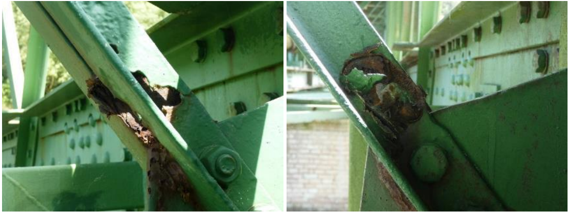
Figura 41. Diagonales con perforaciones debidas a la corrosión en la unión con el cordón inferior. Izquierda, módulo 6 del vano 2 y, derecha, módulo 5 del vano 1.
