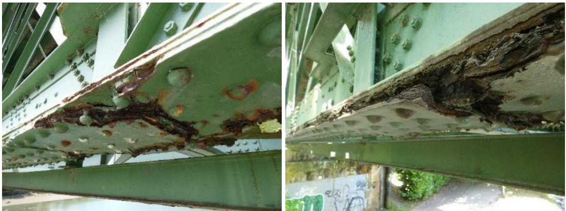
Figura 28. Fuertes pérdidas de sección por corrosión en el ala inferior del cordón inferior. Izquierda, módulo 9 del vano 2 aguas arriba, derecha, módulo 3 del vano 1 aguas arriba.
