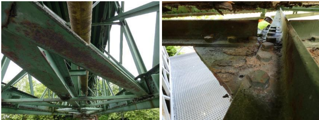
Figura 39. Diagonales que conforman la cruz de San Andrés de la celosía horizontal con corrosiones superficiales de poca intensidad. Izquierda, módulo 8 del vano 1 y, derecha, módulo 1 del vano 1.
