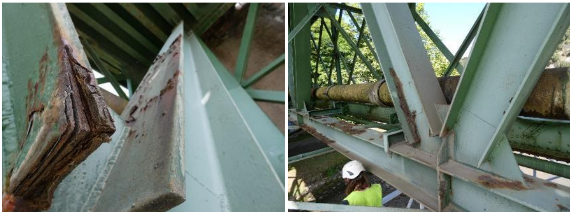
Figura 23. Izquierda, paquetes de hidróxido en el ala de la diagonal en el módulo 10 del vano2. Derecha, corrosiones en el ala de la diagonal en su parte baja en el módulo 5 del vano 1.
