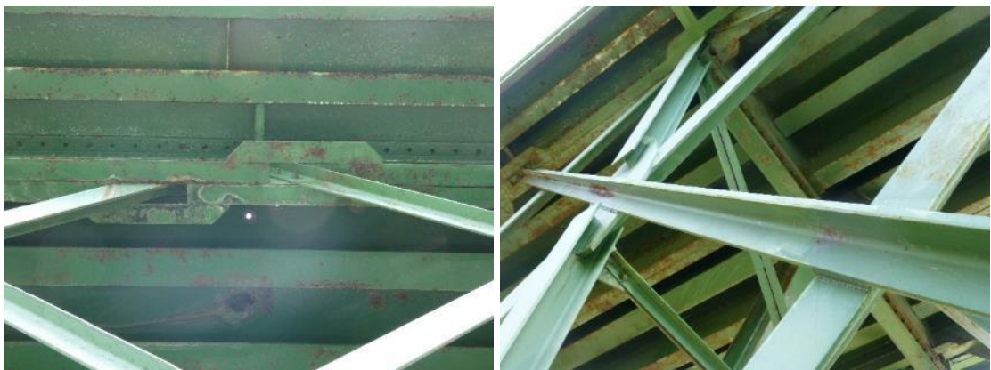
Figura 31. Corrosión superficial en celosías laterales. Izquierda, cordón superior del módulo 5 del vano 2 aguas arriba. Derecha, diagonal del módulo 8 del vano 2 aguas abajo.
