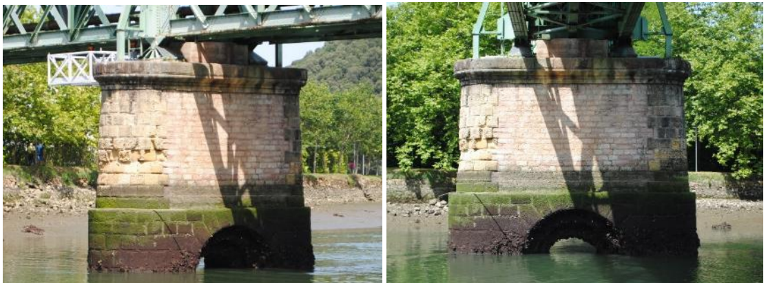
Figura 19. Izquierda, pérdida de material en sillares del tajamar semicircular del lado sur, incluso arenización en los sillares superiores. Derecha, pátinas biológicas, pátinas negras y humedades en el alzado del lado este de la pila.
