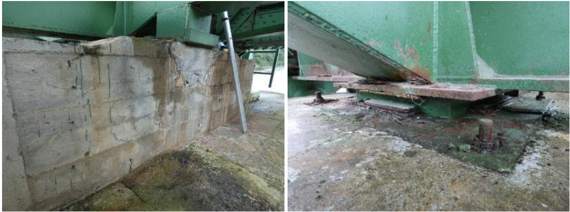
Figura 20. Izquierda, recrecido de hormigón con desconches en su cara este sobre la pila 1. Derecha, chapas perimetrales al neopreno con paquetes de hidróxido.
