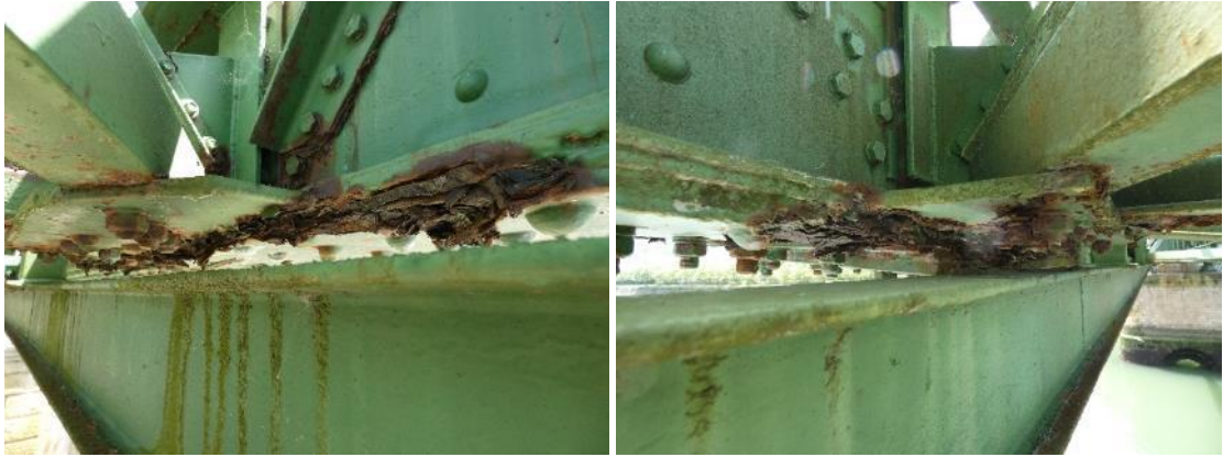
Figura 35. Cartelas de unión entre diagonal y cordón inferior en el módulo 8 del vano 2 con fuertes pérdidas de sección.
