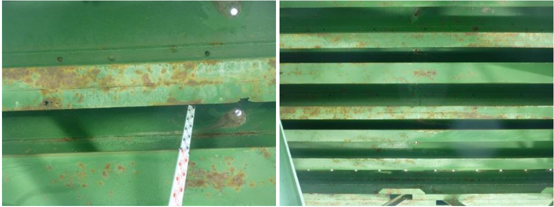
Figura 47. Corrosiones superficiales, incluso alguna perforación, en la losa ortótropa en el módulo 6 del vano 2.
