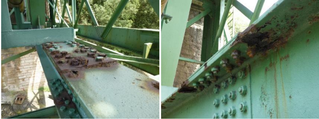
Figura 22. Uniones de continuidad del cordón inferior afectadas por la corrosión. Izquierda, módulo 8 del vano 2 y, derecha, módulo 9 del vano 2.
