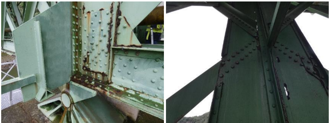
Figura 30. Fuertes corrosiones, llegando a perforar las chapas incluso, en el montante de apoyo sobre la pila 1 en el lado de aguas abajo.
