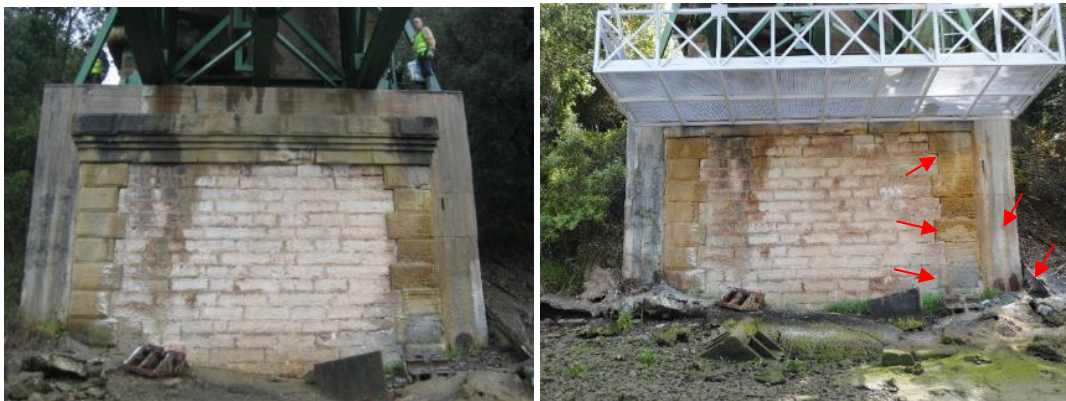
Figura 16. Comparación de la evolución del alzado del estribo 2 desde la inspección principal realizada en 2011. Izquierda, imagen de 2011, y derecha, imagen de 2020, donde se indican mediante flechas en rojo las zonas que presentan una evolución negativa de los daños.
