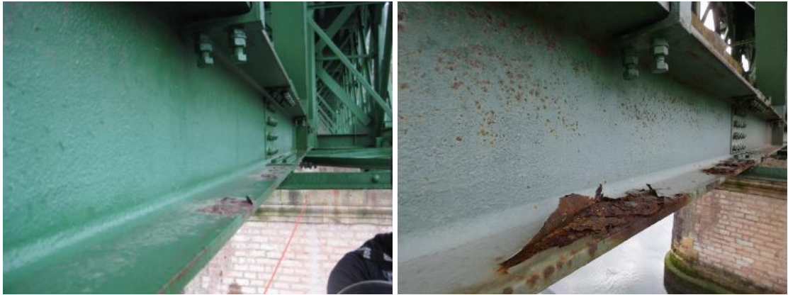
Figura 24. Cordón inferior del módulo 8 del vano 1. Imagen tomada en 2011, izquierda, y en 2020, derecha.
