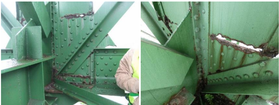
Figura 33. Montante de apoyo aguas abajo sobre la pila 1. Imagen tomada en 2011, izquierda, y en 2020, derecha.
