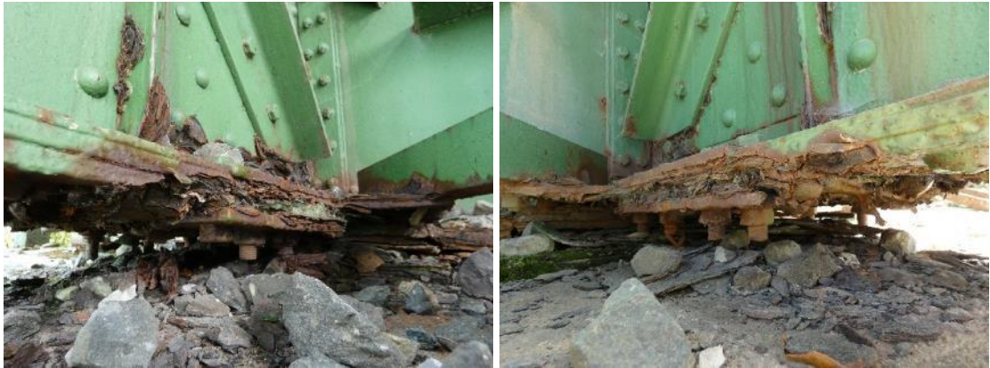
Figura 18. Acumulación de herrumbre en los aparatos de apoyo de las celosías laterales sobre el estribo 2.
