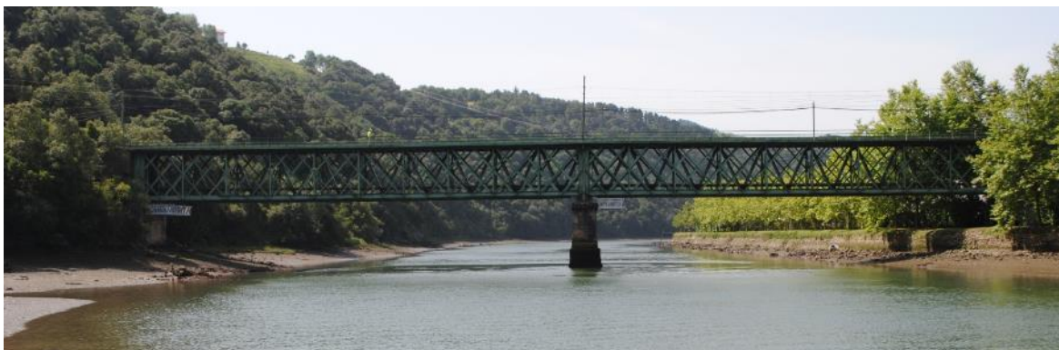
Figura 14. Alzado del puente desde aguas abajo tomada durante la inspección especial realizada.
