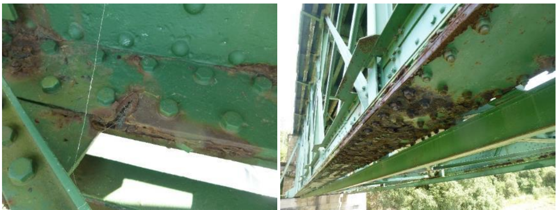
Figura 27. Izquierda, fuerte pérdida de sección en el ala inferior del cordón inferior de aguas arriba en módulo 6 del vano 2. Derecha, corrosión generalizada en el refuerzo del cordón inferior de aguas abajo en el módulo 6 del vano 2.
