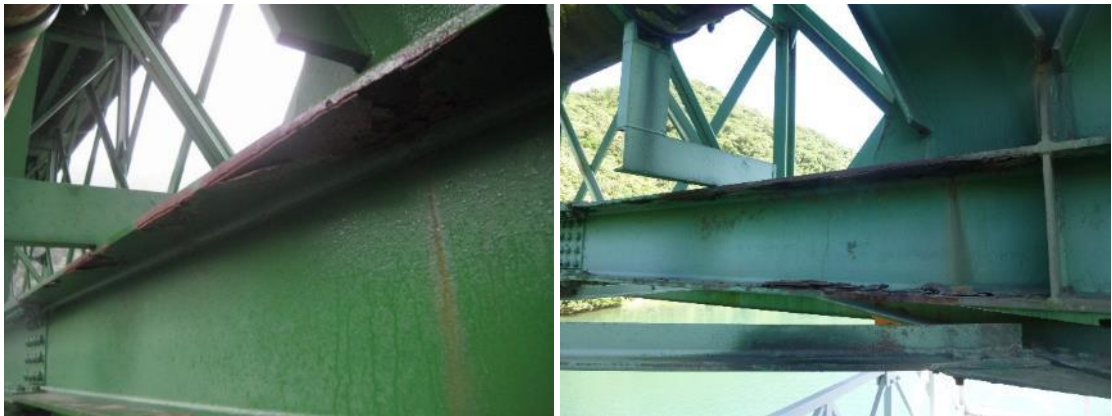
Figura 25. Cordón inferior del módulo 2 del vano 2. Imagen tomada en 2011, izquierda, y en 2020, derecha.
