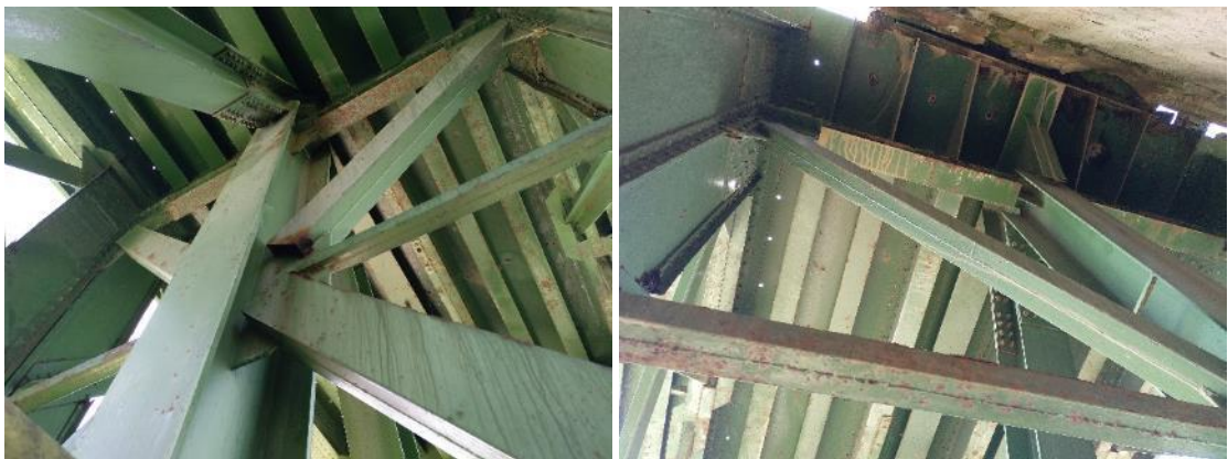
Figura 45. Arriostramiento transversal de pila, izquierda, y estribo 2, derecha, con corrosiones superficiales.
