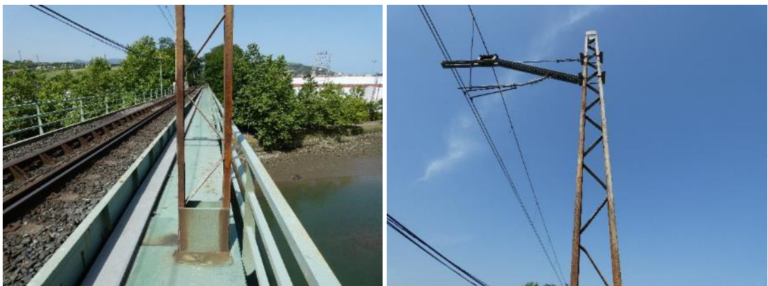
Figura 54. Poste de catenaria situado sobre el puente con corrosiones superficiales.
