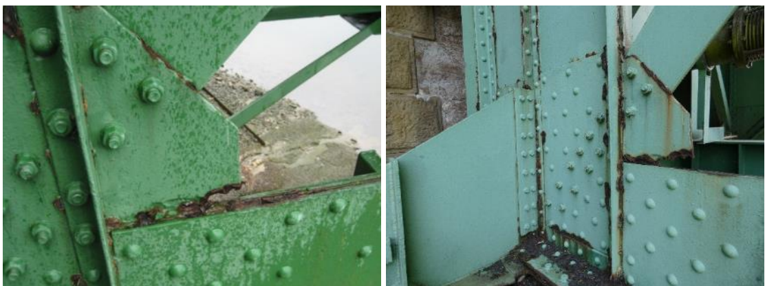
Figura 34. Cartela de unión del montante de apoyo aguas abajo sobre el estribo 2. Imagen tomada en 2011, izquierda, y en 2020, derecha.
