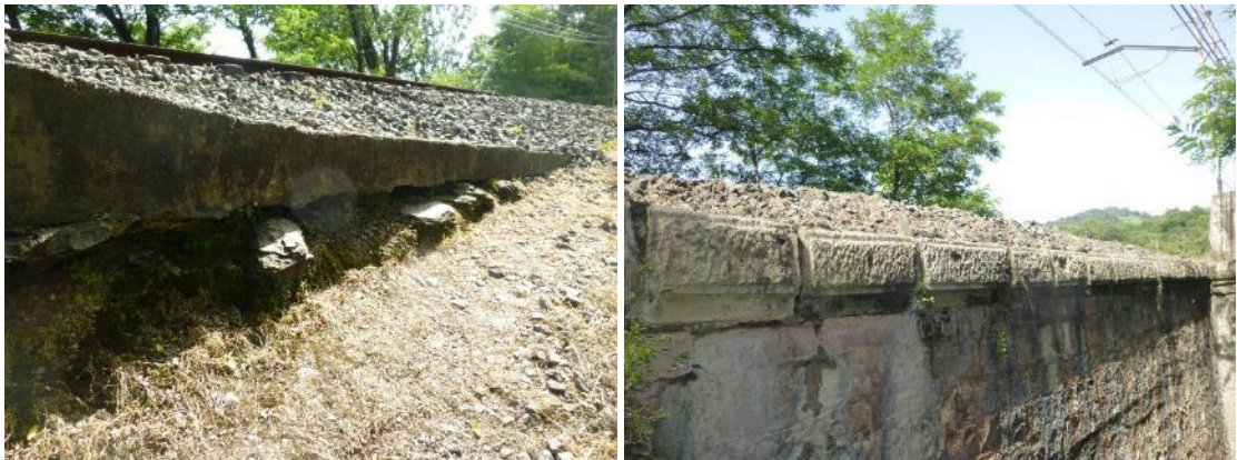
Figura 53. Izquierda, descalce del zuncho que envuelve a los servicios en el lateral norte del muro en vuelta del estribo 1. Derecha, derrame del balasto sobre el muro envuelta sur del estribo 1.
