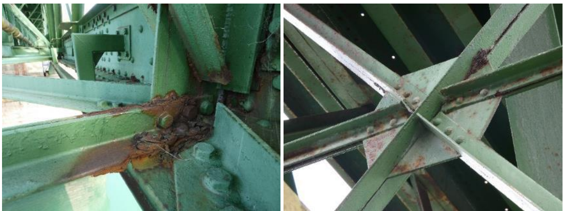
Figura 43. Corrosiones en las cartelas de unión del sistema de arriostramiento vertical. Izquierda, cartela de unión con cordón inferior en el módulo 3 del vano 2 y, derecha, cartela de unión central en el módulo 8 del vano 1.
