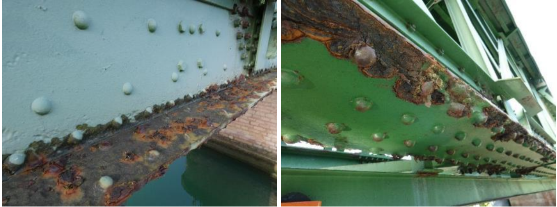
Figura 26. Corrosiones con fuertes pérdidas de sección en el cordón inferior de la celosía de aguas abajo en el módulo 3 del vano 2.
