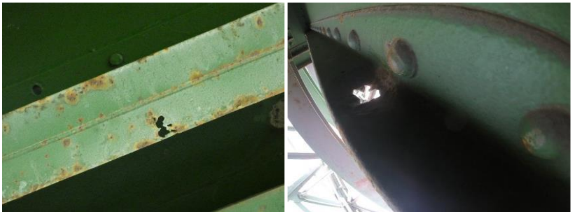
Figura 48. Detalle de perforación puntual por corrosión en el rigidizador longitudinal de la losa ortótropa del módulo 3 del vano 1.
