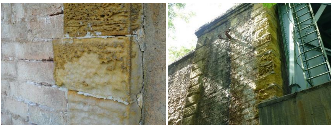
Figura 17. Arenización de sillares en los laterales de los estribos. Izquierda, borde lateral sur del estribo 2, y derecha, borde lateral sur del estribo 1.
