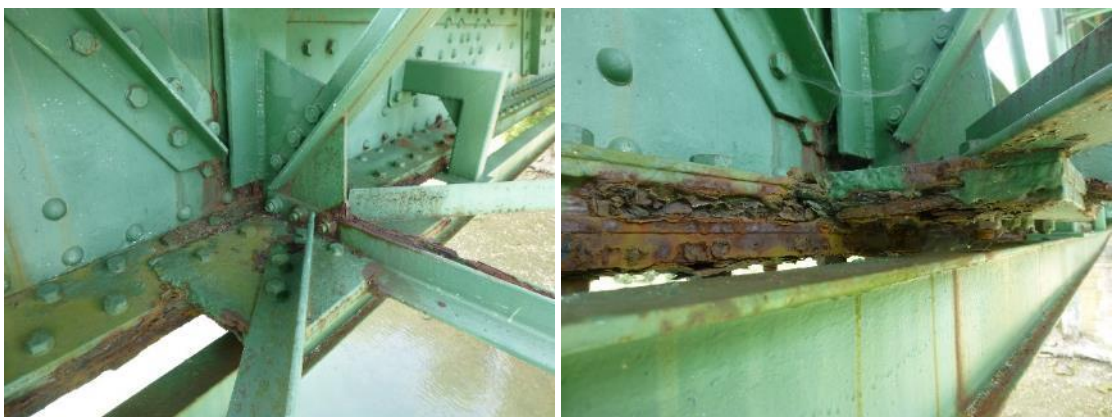
Figura 37. Cartela de unión entre diagonal y cordón inferior, previamente ya reforzada, en el módulo 6 del vano 2 con fuertes corrosiones.
