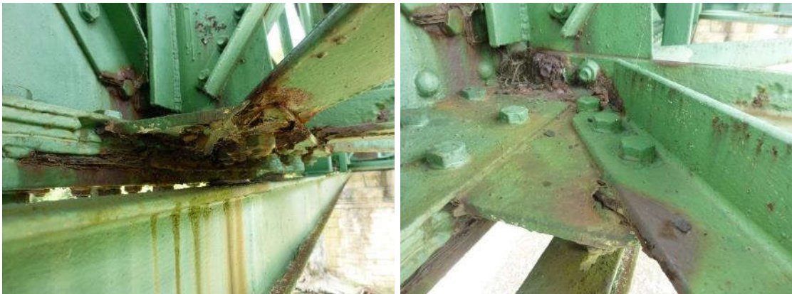
Figura 23. Cartela de unión entre diagonal y cordón inferior en el módulo 7 del vano 2 con fuertes pérdidas de sección.
