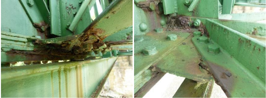
Figura 36. Cartela de unión entre diagonal y cordón inferior en el módulo 7 del vano 2 con fuertes pérdidas de sección.
