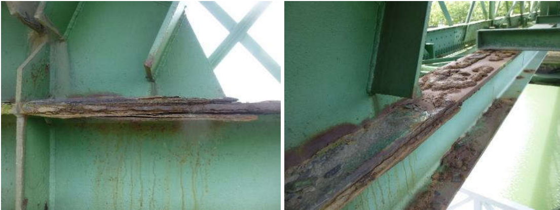
Figura 8. Paquetes de hidróxido en las alas del cordón inferior en el módulo 7 del vano 2.
