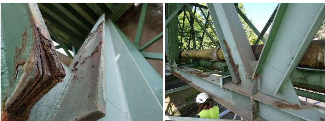
Figura 10. Izquierda, paquetes de hidróxido en el ala de la diagonal en el módulo 10 del vano2. Derecha, corrosiones en el ala de la diagonal en su parte baja en el módulo 5 del vano 1.
