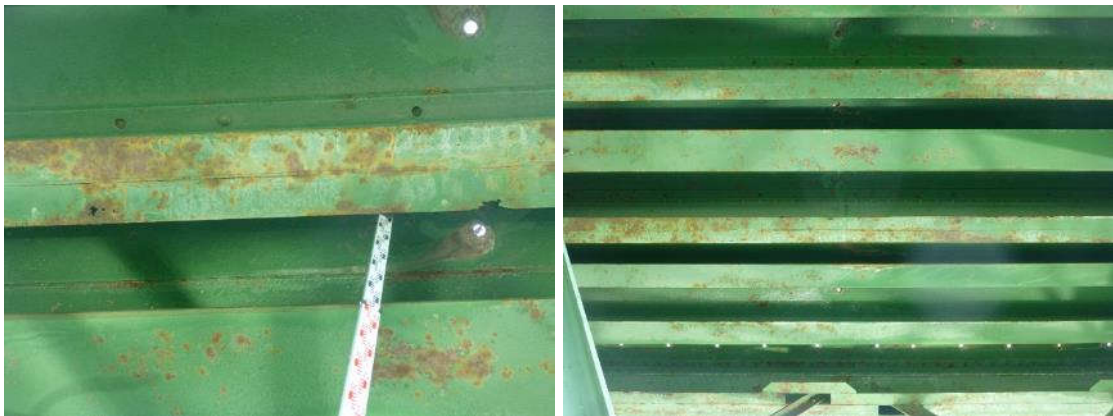
Figura 34. Corrosiones superficiales, incluso alguna perforación, en la losa ortótropa en el módulo 6 del vano 2.
