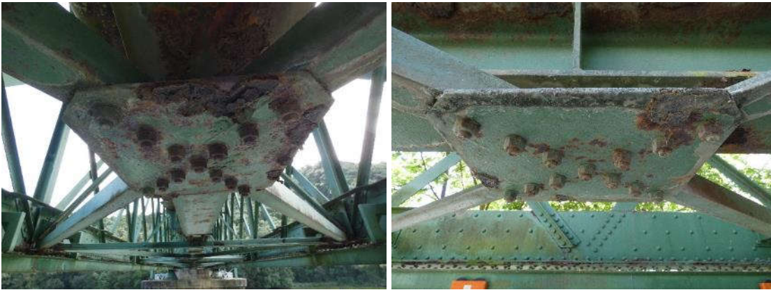
Figura 25. Cartela para el cruce de diagonales con corrosiones superficiales y acompañadas del algún paquete de hidróxido puntual. Izquierda, módulo 6 del vano 1 y, derecha, módulo 2 del vano 1.
