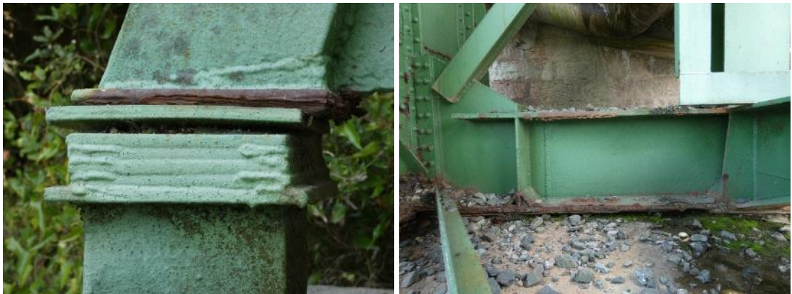
Figura 46. Izquierda, falta de apoyo en el arriostramiento o puntal del cordón superior en el estribo 2 aguas abajo. Derecha, corrosiones acompañadas de paquetes de hidróxido en la viga transversal inferior del estribo 2 aguas abajo.
