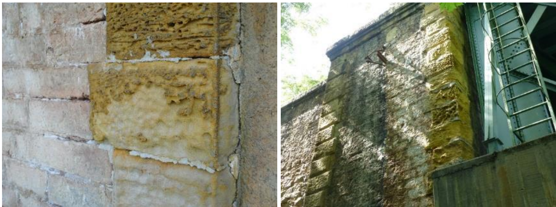
Figura 17. Arenización de sillares en los laterales de los estribos. Izquierda, borde lateral sur del estribo 2, y derecha, borde lateral sur del estribo 1.
