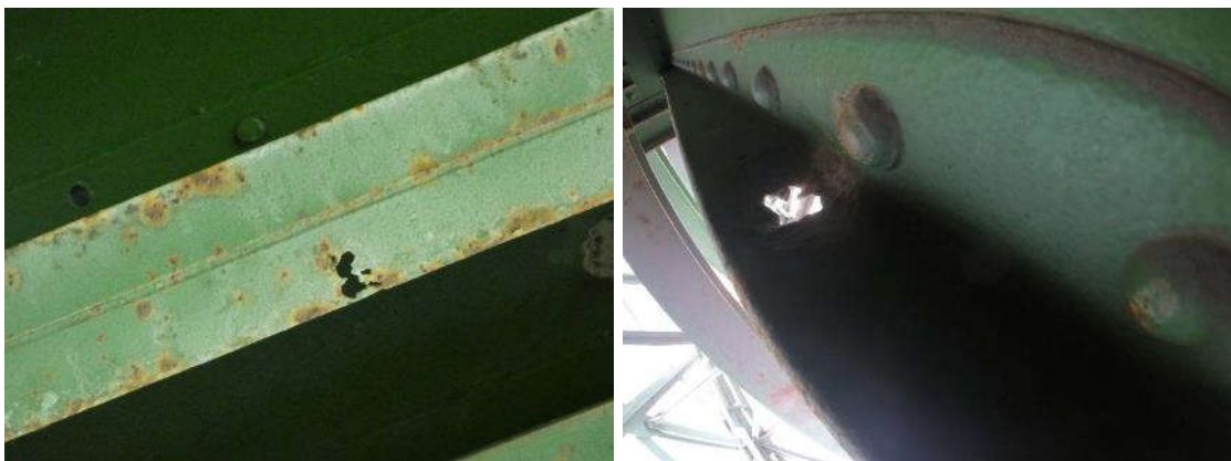
Figura 35. Detalle de perforación puntual por corrosión en el rigidizador longitudinal de la losa ortótropa del módulo 3 del vano 1.
