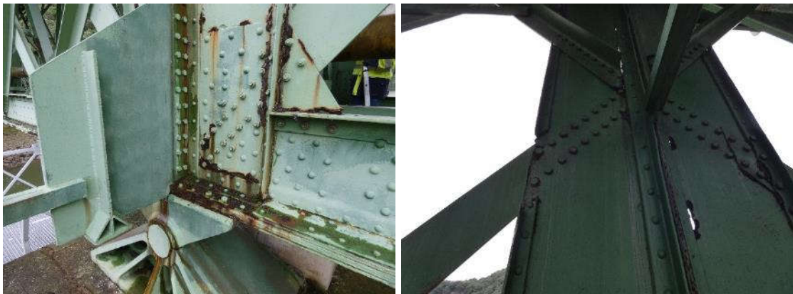
Figura 17. Fuertes corrosiones, llegando a perforar las chapas incluso, en el montante de apoyo sobre la pila 1 en el lado de aguas abajo.
