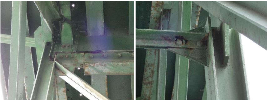
Figura 31. Corrosiones puntuales en la viga transversal superior, izquierda, y tirante intermedio, derecha, del módulo 9 del vano 1.
