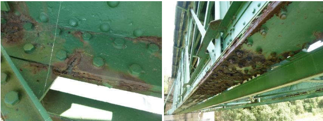
Figura 14. Izquierda, fuerte pérdida de sección en el ala inferior del cordón inferior de aguas arriba en módulo 6 del vano 2. Derecha, corrosión generalizada en el refuerzo del cordón inferior de aguas abajo en el módulo 6 del vano 2.
