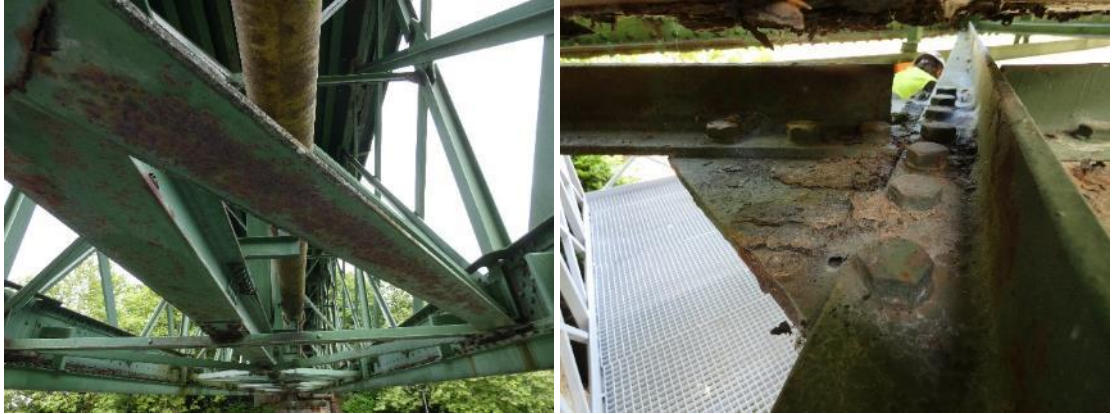
Figura 39. Diagonales que conforman la cruz de San Andrés de la celosía horizontal con corrosiones superficiales de poca intensidad. Izquierda, módulo 8 del vano 1 y, derecha, módulo 1 del vano 1.
