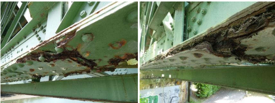
Figura 15. Fuertes pérdidas de sección por corrosión en el ala inferior del cordón inferior. Izquierda, módulo 9 del vano 2 aguas arriba, derecha, módulo 3 del vano 1 aguas arriba.
