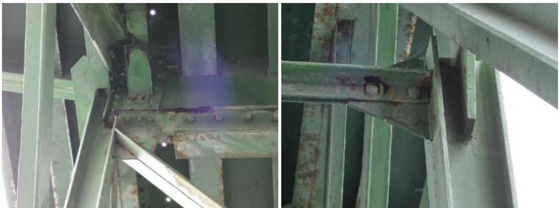
Figura 44. Corrosiones puntuales en la viga transversal superior, izquierda, y tirante intermedio, derecha, del módulo 9 del vano 1.
