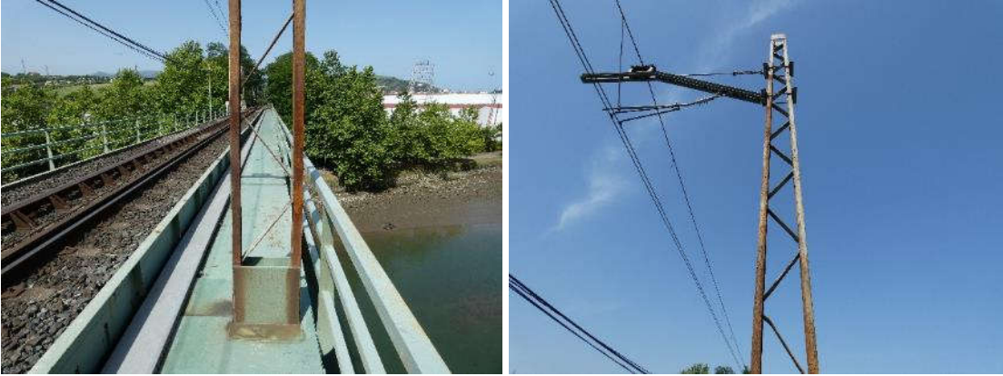
Figura 41. Poste de catenaria situado sobre el puente con corrosiones superficiales.
