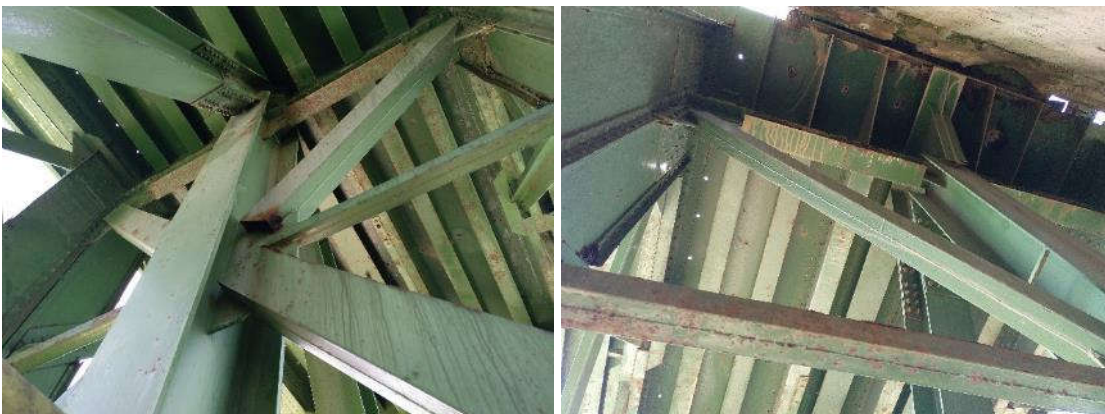
Figura 32. Arriostamiento transversal de pila, izquierda, y estribo 2, derecha, con corrosiones superficiales.
