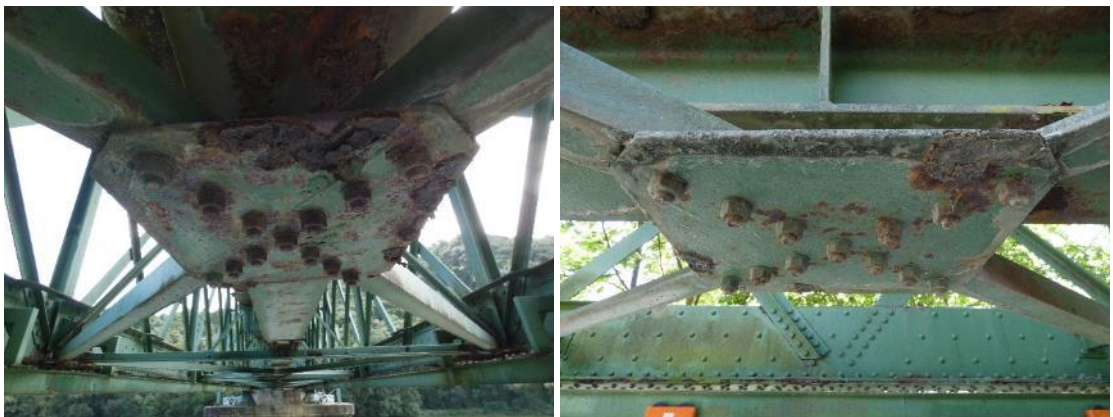
Figura 38. Cartela para el cruce de diagonales con corrosiones superficiales y acompañadas del algún paquete de hidróxido puntual. Izquierda, módulo 6 del vano 1 y, derecha, módulo 2 del vano 1.
