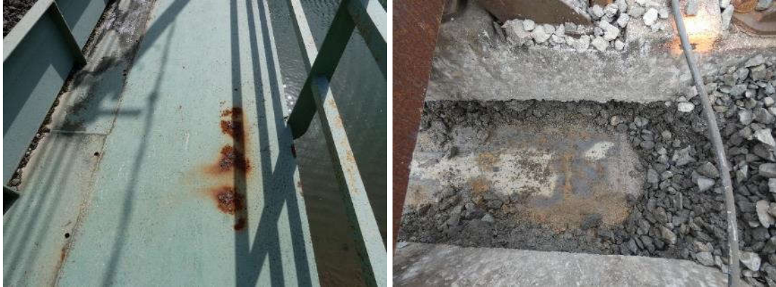
Figura 39. Izquierda, corrosiones puntuales en la chapa de piso del paseo de aguas arriba. Derecha, ligeras pátinas de corrosión en la chapa de piso bajo el balasto.
