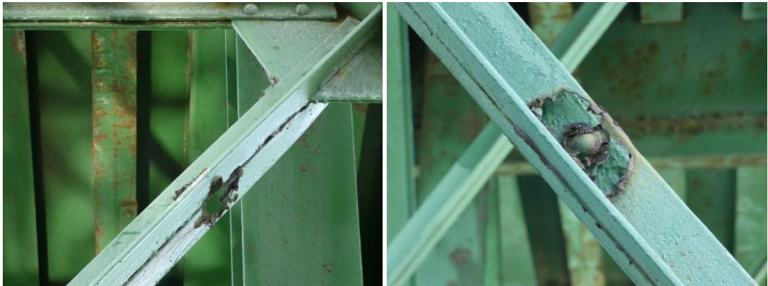
Figura 40. Diagonales con perforaciones debidas a la corrosión en la mitad superior. Izquierda, módulo 4 del vano 2 y, derecha, módulo 1 del vano 2.
