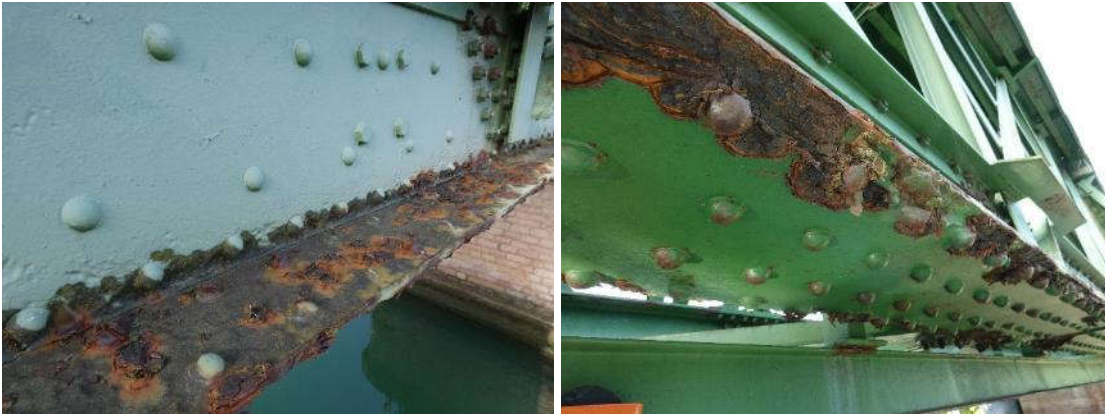
Figura 13. Corrosiones con fuertes pérdidas de sección en el cordón inferior de la celosía de aguas abajo en el módulo 3 del vano 2.
