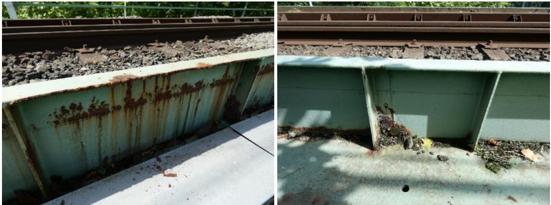
Figura 51. Corrosiones, algunas de ellas acompañadas de herrumbre, en el murete guardabalasto.
