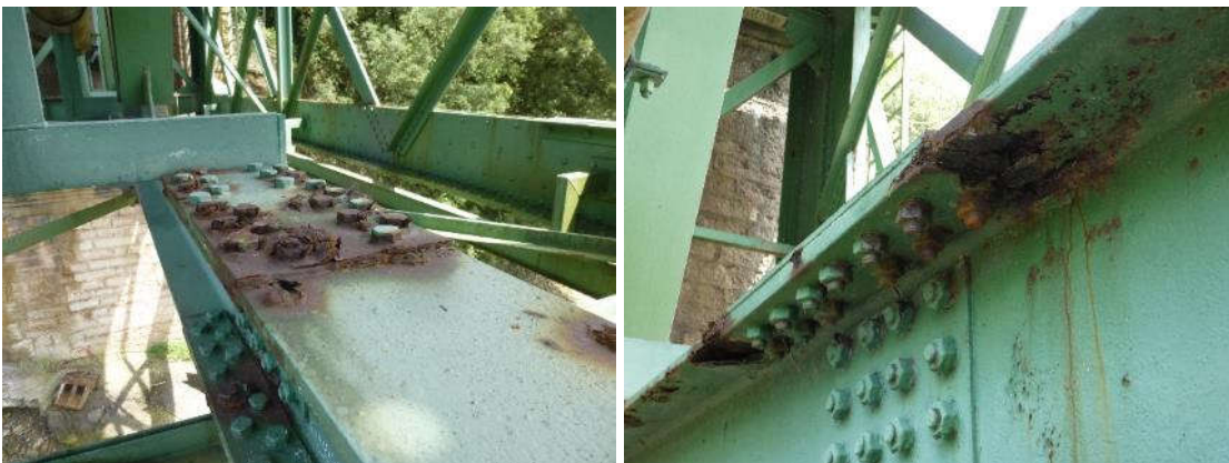
Figura 9. Uniones de continuidad del cordón inferior afectadas por la corrosión. Izquierda, módulo 8 del vano 2 y, derecha, módulo 9 del vano 2.
