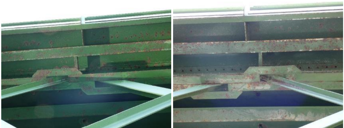
Figura 49. Corrosiones superficiales en la parte volada lateral de la losa ortótropa con corrosiones superficiales. Izquierda, módulo 3 del vano 2 y, derecha, módulo 6 del vano 1.
