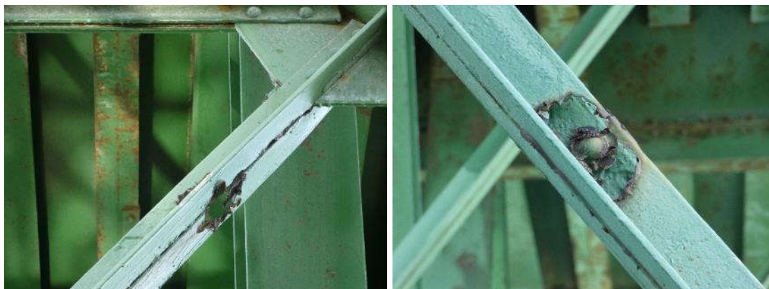
Figura 27. Diagonales con perforaciones debidas a la corrosión en la mitad superior. Izquierda, módulo 4 del vano 2 y, derecha, módulo 1 del vano 2.
