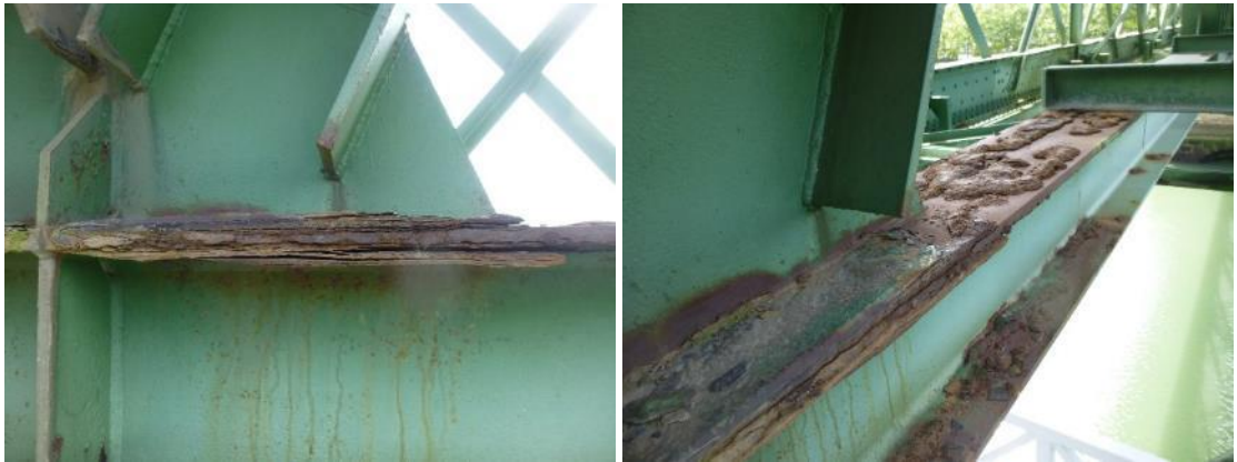
Figura 21. Paquetes de hidróxido en las alas del cordón inferior en el módulo 7 del vano 2.
