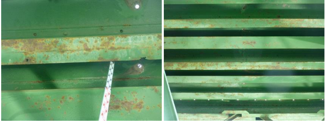
Figura 47. Corrosiones superficiales, incluso alguna perforación, en la losa ortótropa en el módulo 6 del vano 2.
