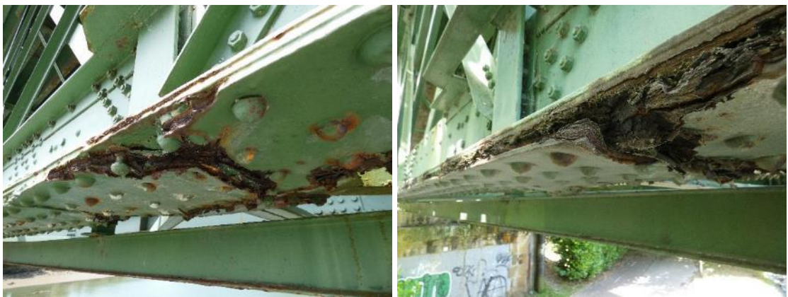
Figura 28. Fuertes pérdidas de sección por corrosión en el ala inferior del cordón inferior. Izquierda, módulo 9 del vano 2 aguas arriba, derecha, módulo 3 del vano 1 aguas arriba.
