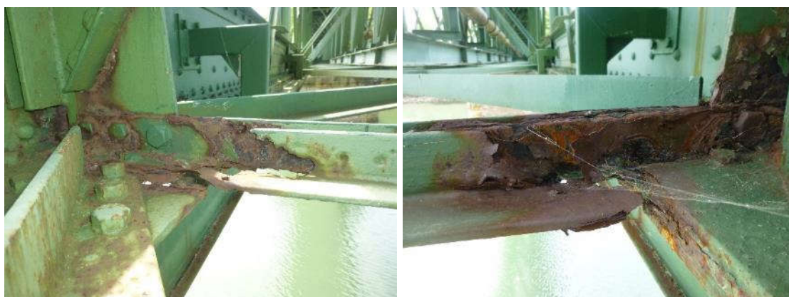
Figura 29. Tirantes inferiores con perforaciones debidas a la corrosión en la unión con el cordón inferior en el módulo 7 del vano 2.
