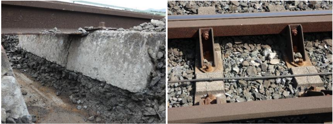
Figura 50. Fisuras por fatiga en las traviesas de hormigón. Derecha, rotura seccional del elemento coincidiendo con el carril y, derecha, fisuras alineadas con el eje del propio elemento.
