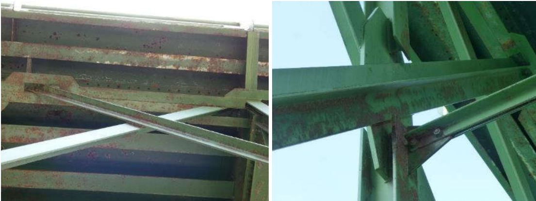
Figura 19. Corrosión superficial en celosías laterales. Izquierda, cordón superior del módulo 9 del vano 2 aguas abajo. Derecha, contradiagonal del módulo 2 del vano 2 aguas abajo.
