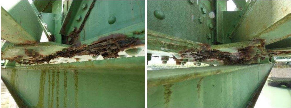
Figura 22. Cartelas de unión entre diagonal y cordón inferior en el módulo 8 del vano 2 con fuertes pérdidas de sección.
