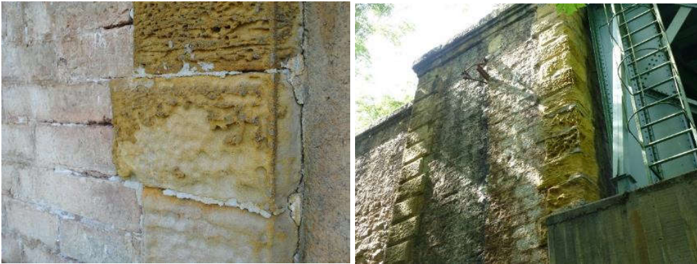
Figura 4. Arenización de sillares en los laterales de los estribos. Izquierda, borde lateral sur del estribo 2, y derecha, borde lateral sur del estribo 1.
