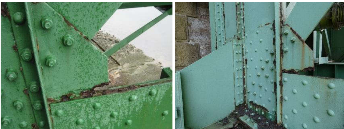
Figura 21. Cartela de unión del montante de apoyo aguas abajo sobre el estribo 2. Imagen tomada en 2011, izquierda, y en 2020, derecha.
