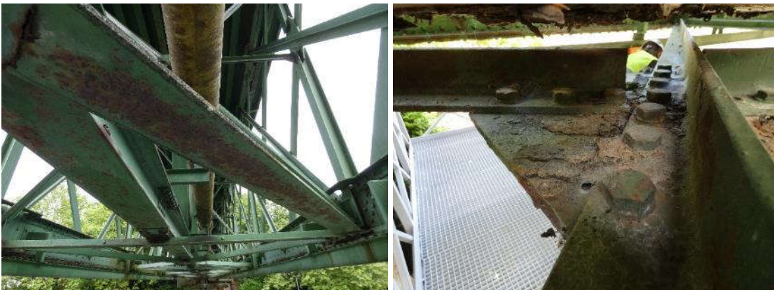
Figura 26. Diagonales que conforman la cruz de San Andrés de la celosía horizontal con corrosiones superficiales de poca intensidad. Izquierda, módulo 8 del vano 1 y, derecha, módulo 1 del vano 1.
