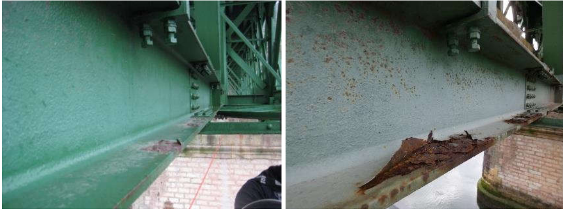
Figura 11. Cordón inferior del módulo 8 del vano 1. Imagen tomada en 2011, izquierda, y en 2020, derecha.
