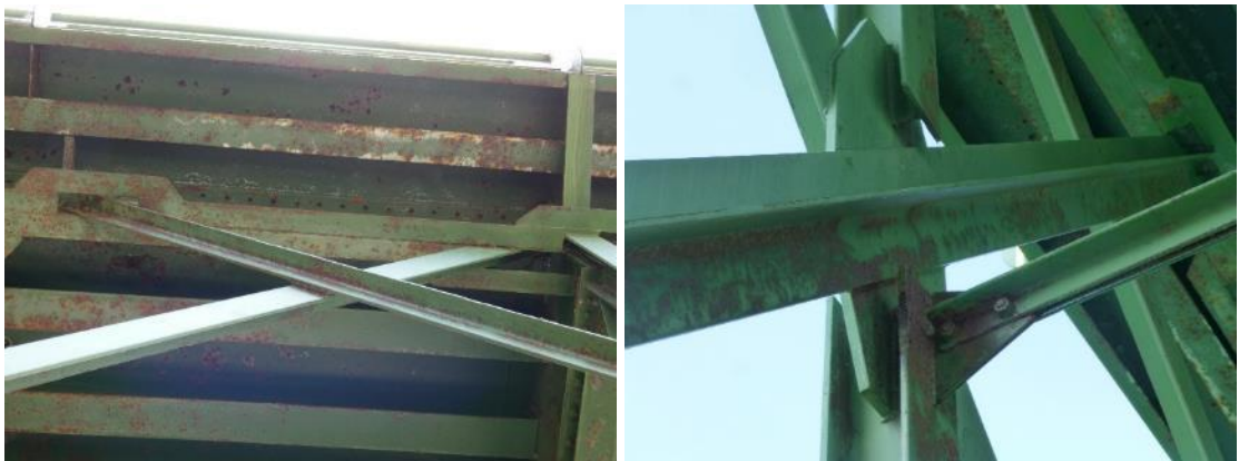
Figura 32. Corrosión superficial en celosías laterales. Izquierda, cordón superior del módulo 9 del vano 2 aguas abajo. Derecha, contradiagonal del módulo 2 del vano 2 aguas abajo.
