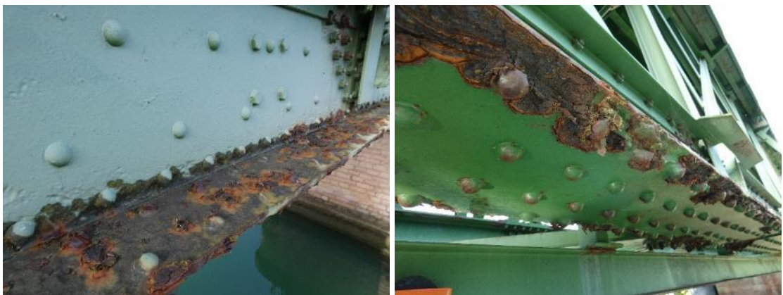
Figura 26. Corrosiones con fuertes pérdidas de sección en el cordón inferior de la celosía de aguas abajo en el módulo 3 del vano 2.
