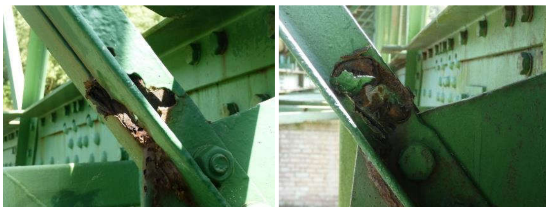
Figura 28. Diagonales con perforaciones debidas a la corrosión en la unión con el cordón inferior. Izquierda, módulo 6 del vano 2 y, derecha, módulo 5 del vano 1.
