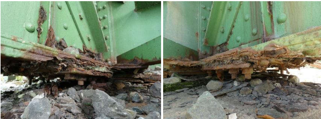
Figura 5. Acumulación de herrumbre en los aparatos de apoyo de las celosías laterales sobre el estribo 2.
