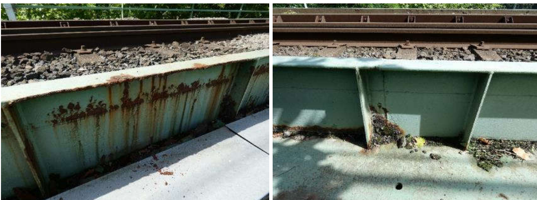
Figura 38. Corrosiones, algunas de ellas acompañadas de herrumbre, en el murete guardabalasto.
