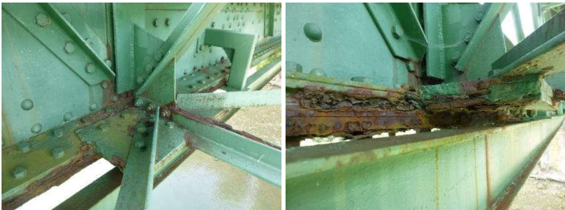
Figura 24. Cartela de unión entre diagonal y cordón inferior, previamente ya reforzada, en el módulo 6 del vano 2 con fuertes corrosiones.
