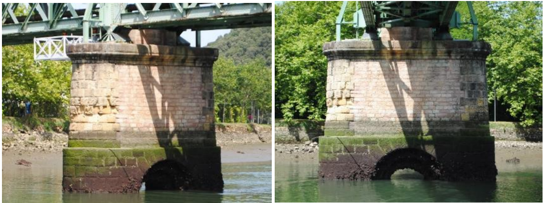
Figura 19. Izquierda, pérdida de material en sillares del tajamar semicircular del lado sur, incluso arenización en los sillares superiores. Derecha, pátinas biológicas, pátinas negras y humedades en el alzado del lado este de la pila.
