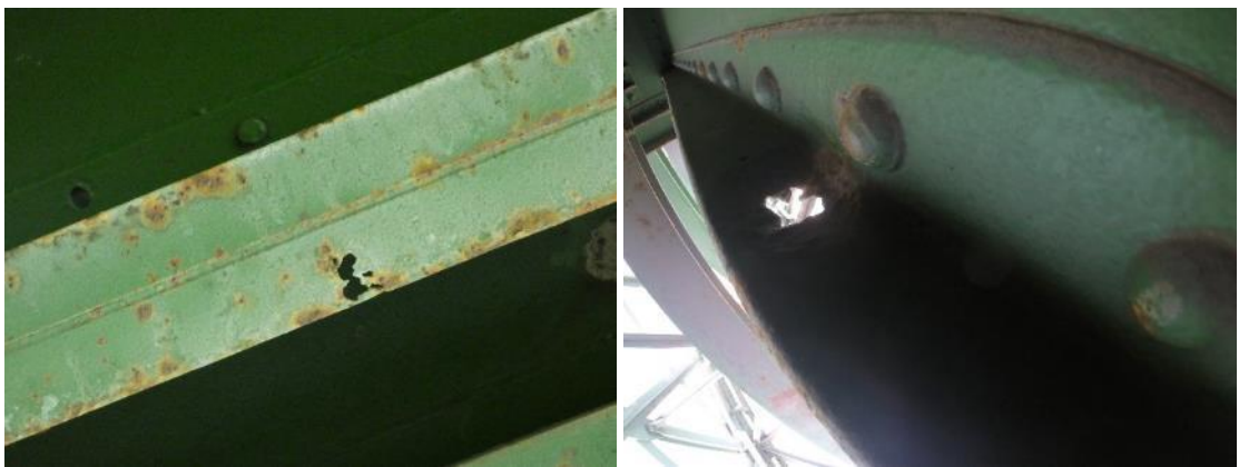
Figura 48. Detalle de perforación puntual por corrosión en el rigidizador longitudinal de la losa ortótropa del módulo 3 del vano 1.
