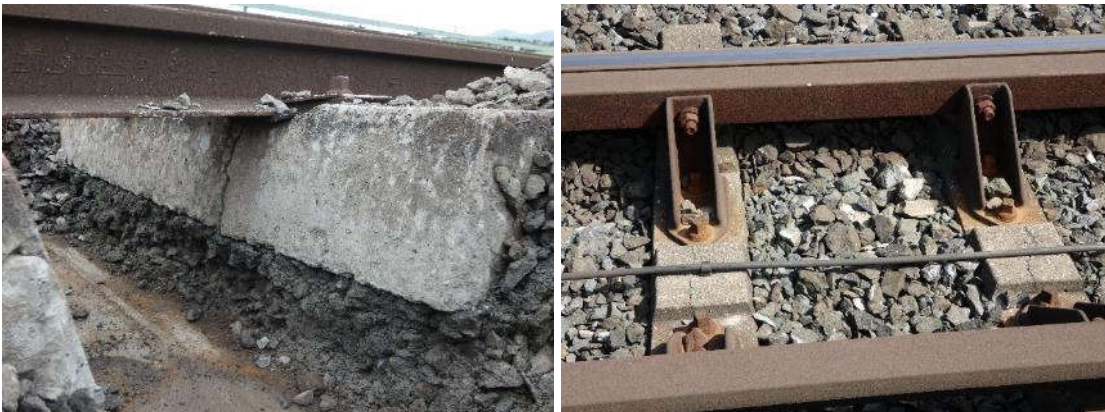
Figura 37. Fisuras por fatiga en las traviesas de hormigón. Derecha, rotura seccional del elemento coincidiendo con el carril y, derecha, fisuras alineadas con el eje del propio elemento.
