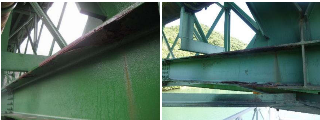
Figura 12. Cordón inferior del módulo 2 del vano 2. Imagen tomada en 2011, izquierda, y en 2020, derecha.
