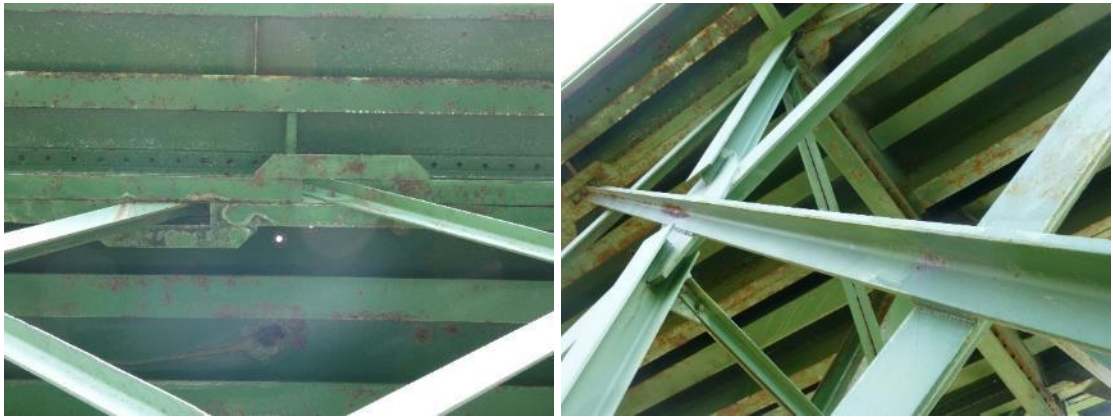
Figura 31. Corrosión superficial en celosías laterales. Izquierda, cordón superior del módulo 5 del vano 2 aguas arriba. Derecha, diagonal del módulo 8 del vano 2 aguas abajo.
