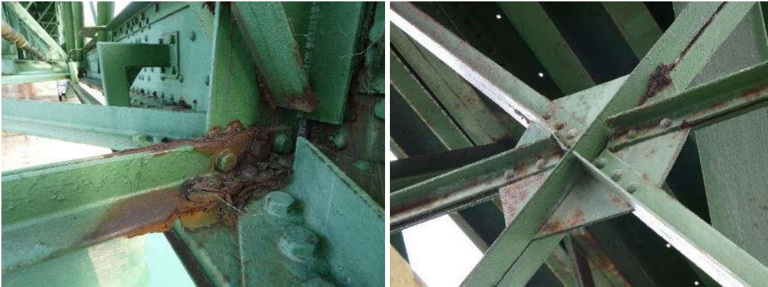
Figura 30. Corrosiones en las cartelas de unión del sistema de arriostamiento vertical. Izquierda, cartela de unión con cordón inferior en el módulo 3 del vano 2 y, derecha, cartela de unión central en el módulo 8 del vano 1.
