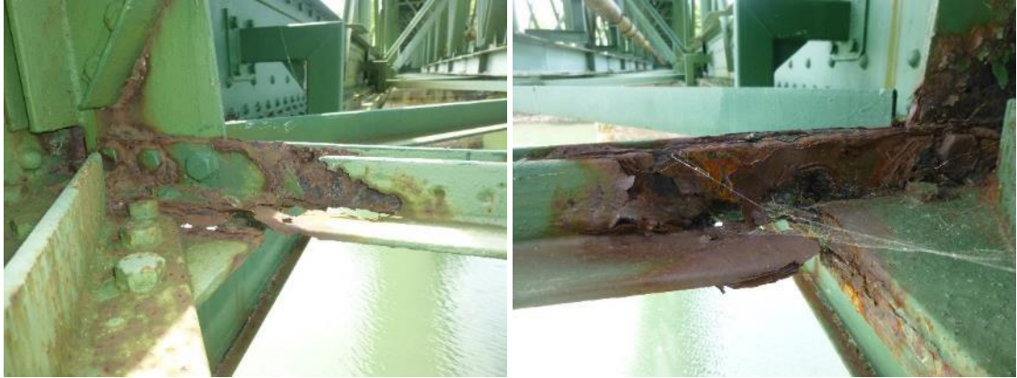
Figura 42. Tirantes inferiores con perforaciones debidas a la corrosión en la unión con el cordón inferior en el módulo 7 del vano 2.
