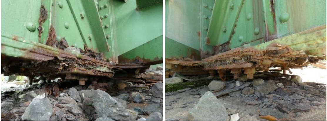
Figura 18. Acumulación de herrumbre en los aparatos de apoyo de las celosías laterales sobre el estribo 2.
