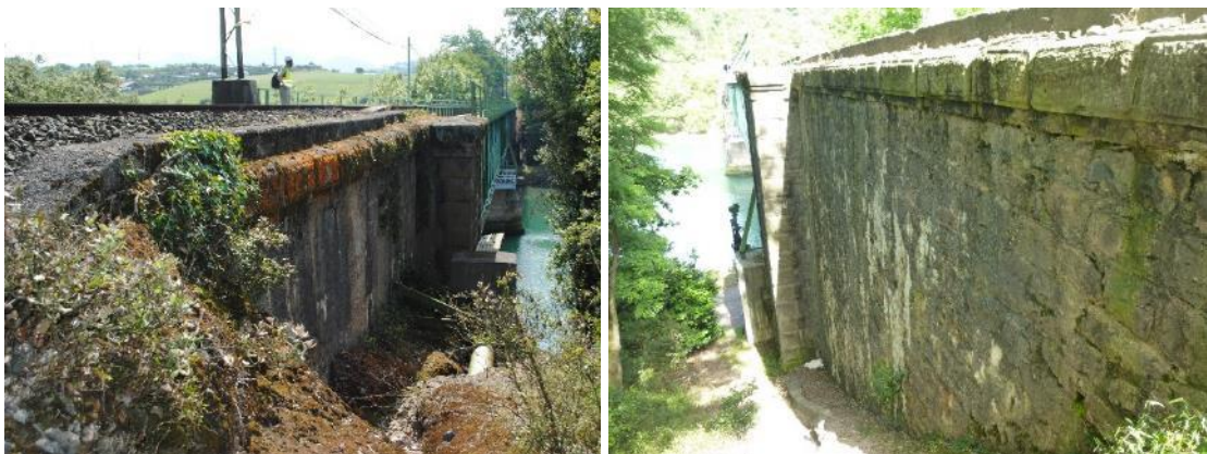
Figura 15. Muros en vuelta del lado norte del estribo 2, izquierda, y estribo 1, derecha, con humedades, pátinas negras, eflorescencias, costras calcáreas, pátinas biológicas y vegetación enraizada.
