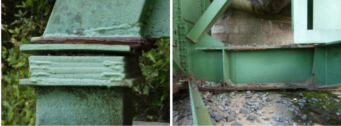
Figura 33. Izquierda, falta de apoyo en el arriostamiento o puntal del cordón superior en el estribo 2 aguas abajo. Derecha, corrosiones acompañadas de paquetes de hidróxido en la viga transversal inferior del estribo 2 aguas abajo.
