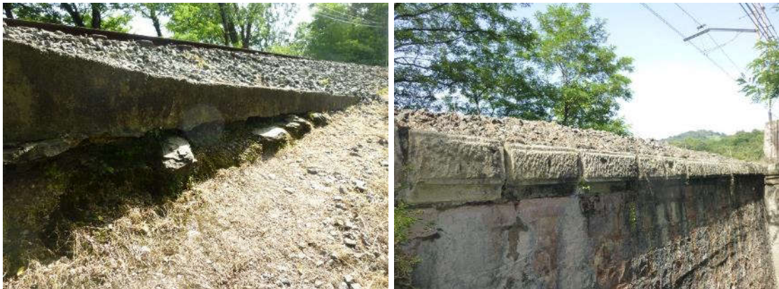
Figura 40. Izquierda, descalce del zuncho que envuelve a los servicios en el lateral norte del muro en vuelta del estribo 1. Derecha, derrame del balasto sobre el muro envuelta sur del estribo 1.
