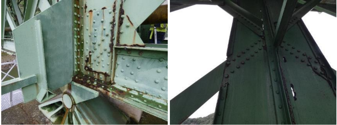
Figura 30. Fuertes corrosiones, llegando a perforar las chapas incluso, en el montante de apoyo sobre la pila 1 en el lado de aguas abajo.
