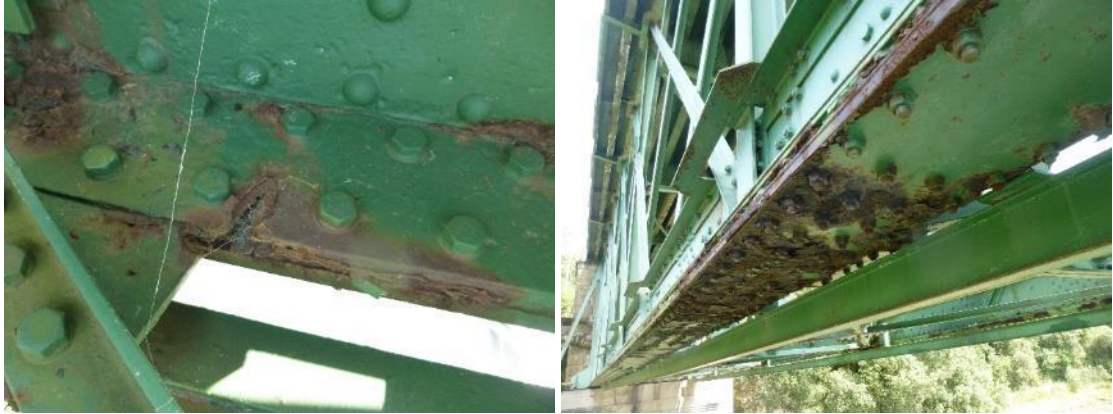
Figura 27. Izquierda, fuerte pérdida de sección en el ala inferior del cordón inferior de aguas arriba en módulo 6 del vano 2. Derecha, corrosión generalizada en el refuerzo del cordón inferior de aguas abajo en el módulo 6 del vano 2.
