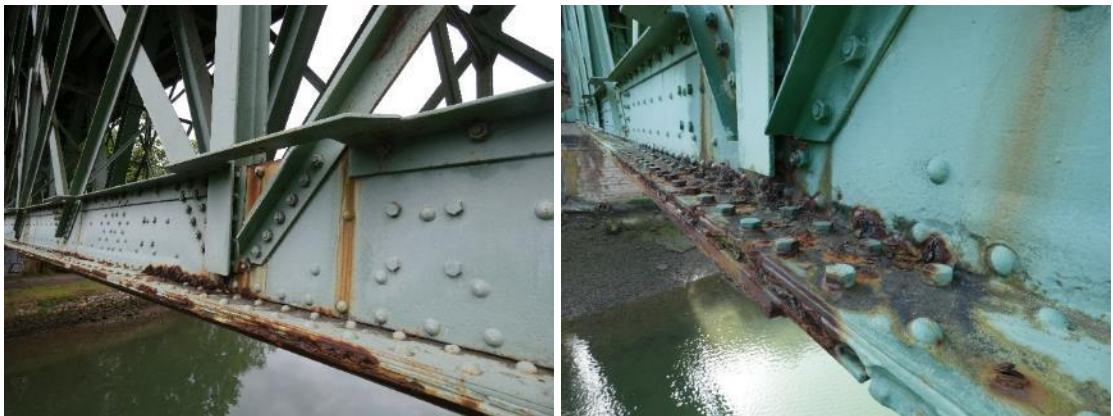
Figura 29. Corrosiones en la unión entre alma y ala del cordón inferior. Izquierda, módulo 8 del vano 1 aguas arriba, derecha, módulo 5 del vano 2 aguas abajo.
