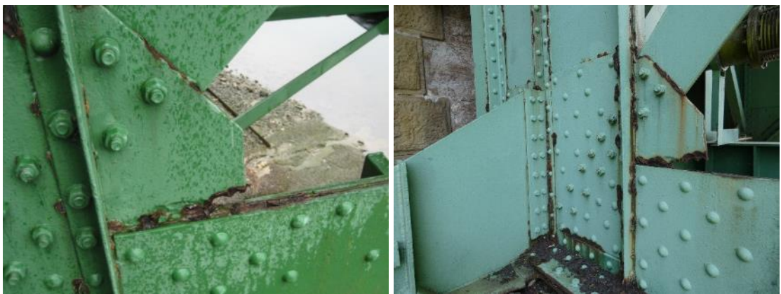
Figura 34. Cartela de unión del montante de apoyo aguas abajo sobre el estribo 2. Imagen tomada en 2011, izquierda, y en 2020, derecha.
