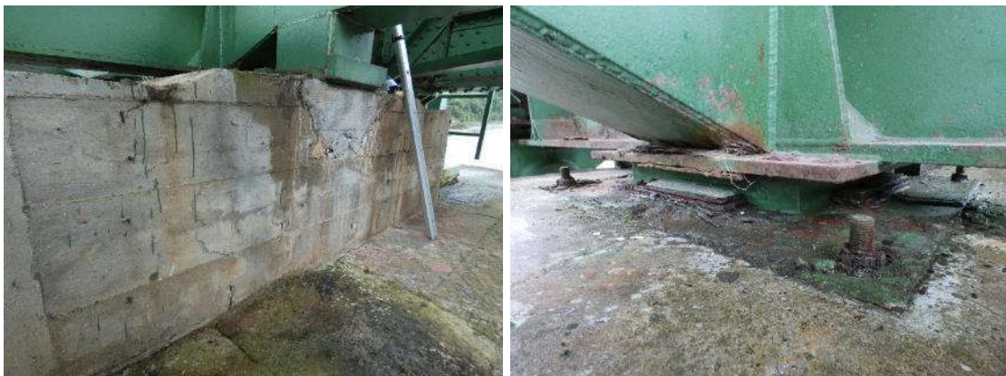
Figura 7. Izquierda, recrado de hormigón con desconches en su cara este sobre la pila 1. Derecha, chapas perimetrales al neopreno con paquetes de hidróxido.
