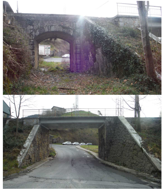
Vista del actual paso inferior y de la OF original adyacente, en desuso
