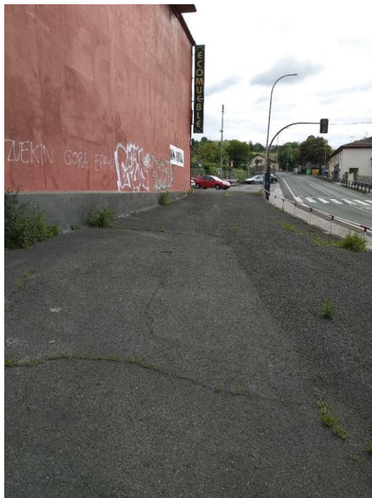
Foto 17 Vista de la zona anexa al acceso a la estación donde se realizará la actuación de la urbanización de la zona..
