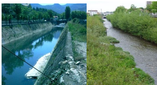
Figura 6. Restauración de la regata Artía, Irun. Antes (foto izquierda) y después (foto derecha).
