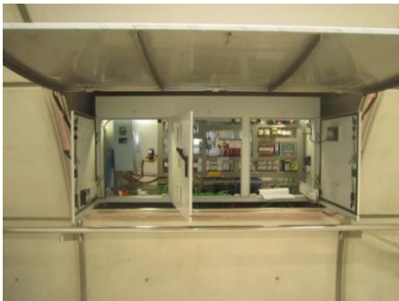
Figura 5. Armario de control y maniobra
