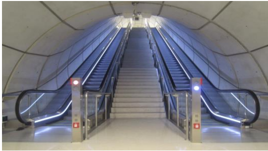
Figura 3. Estructura escaleras mecanizadas
