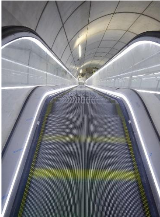
Figura 6. Peldaños de las escaleras mecanizadas
