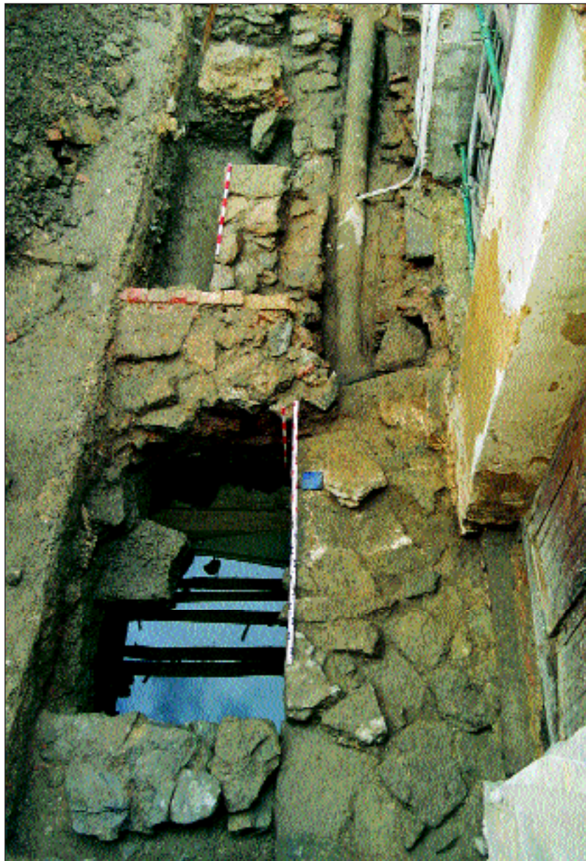
Sector 1. Vista general de la cimentación de la muralla de 1256 conservada en el solar.
