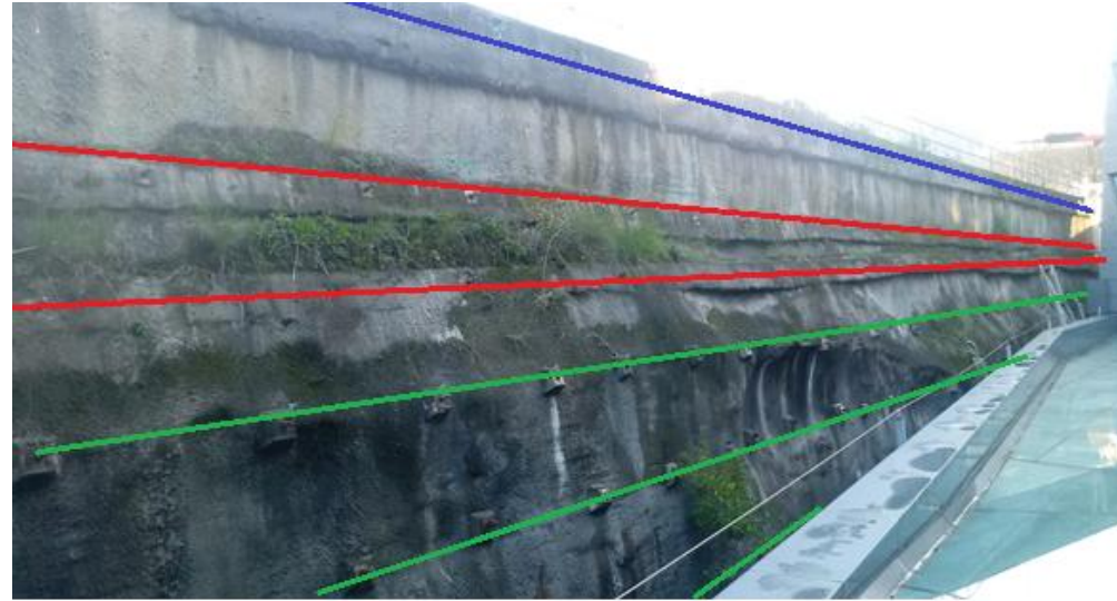
Figura 5.- En azul, línea de anclajes de coronación. En rojo doble línea de anclajes en pie de pantalla de railes. En verde, 3 filas de bulones en alzado sobre roca.
