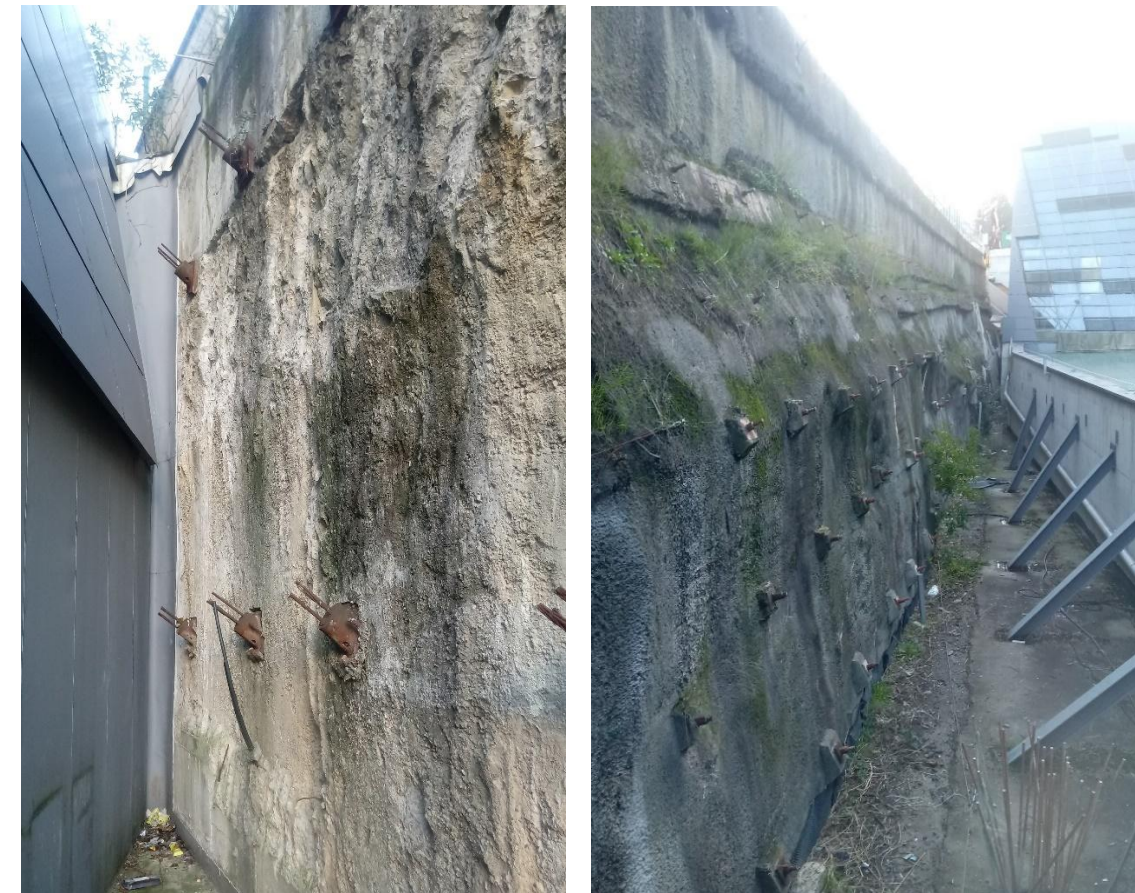
Figura 15.- Vistas de muro pantalla anclado(izq) y contención con raíles y bulones (dcha).
