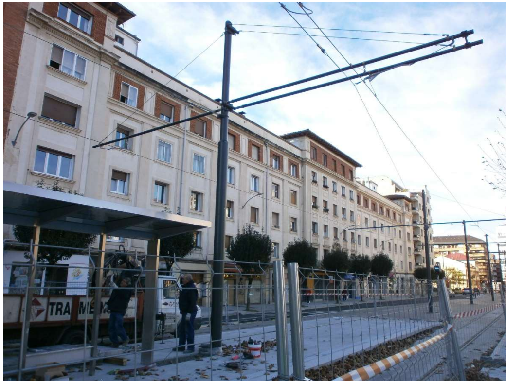
Figura 3. Extremo en P.F. para vía derecha en PK 1+175
