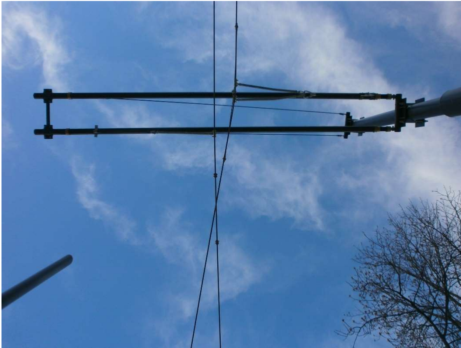
Figura 7. Vista de doble ménsula desde abajo en punto de aguja. Ambas ménsulas están bloqueadas (izquierda de la imagen).
