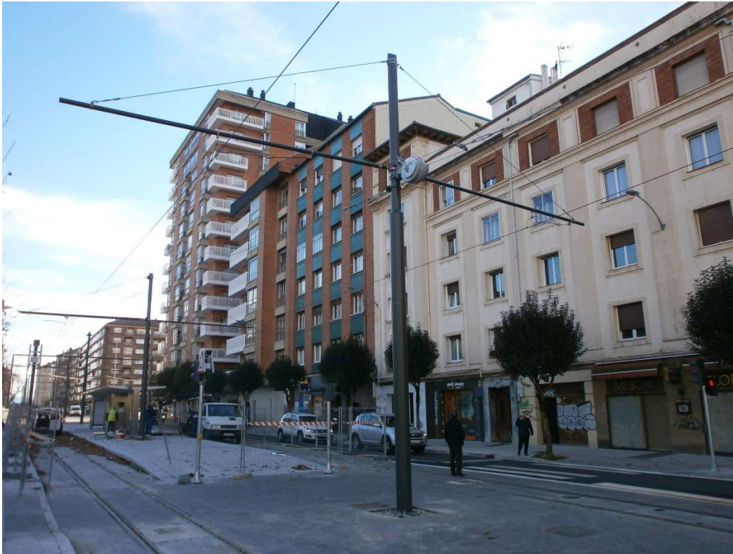
Figura 2. Extremo en P.F. para vía izquierda en PK 1+146
