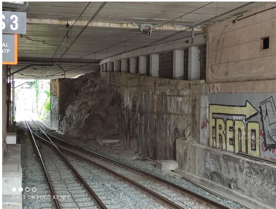
Fotografía 17. Catenaria bajo edificio estación
