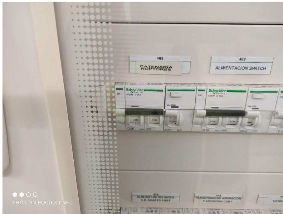
Fotografía 9. Alimentación BT desde cuadro SAI energía
