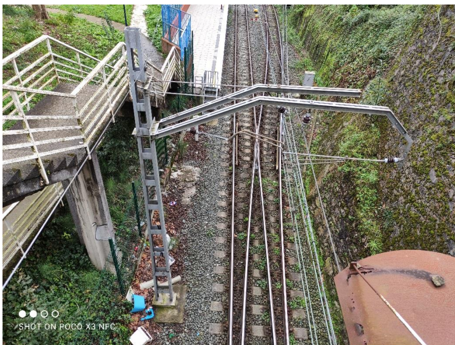
Fotografía 15. Poste de aguja
