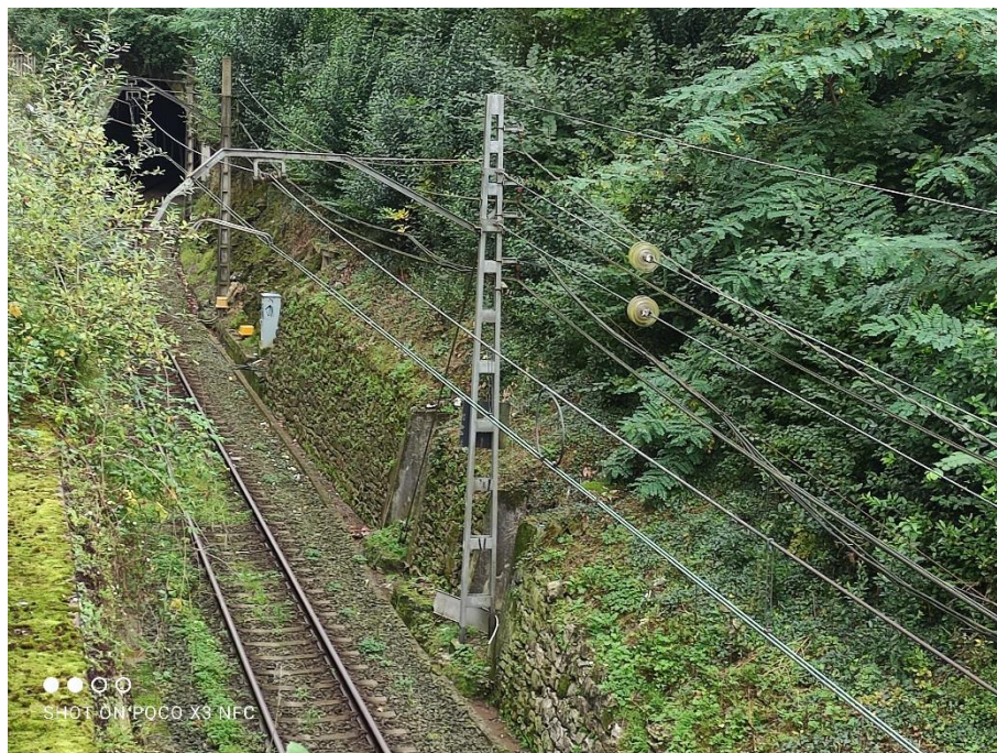
Fotografía 13. Poste de anclaje de aguja
