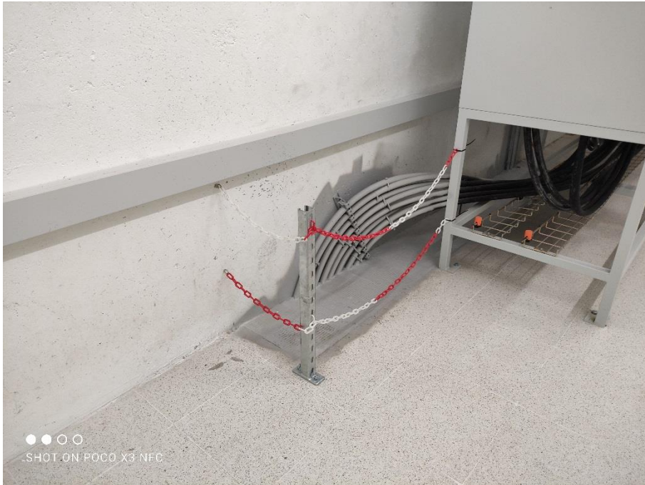
Fotografía 7. Salida de feeders desde cuarto de seccionamiento de catenaria
