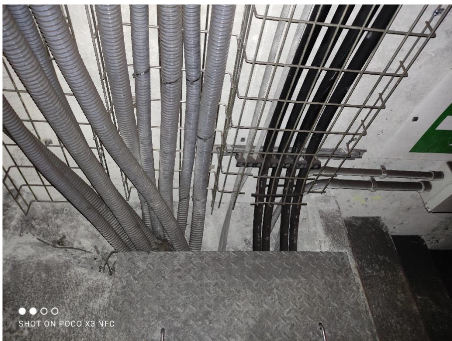
Fotografía 4. Salida cableado de feeder a hastial de túnel
