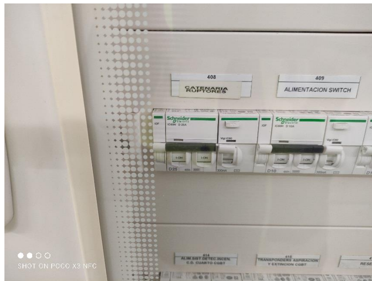
Fotografía 3. CGBT. Estación de Altza. Alimentación ruptores
