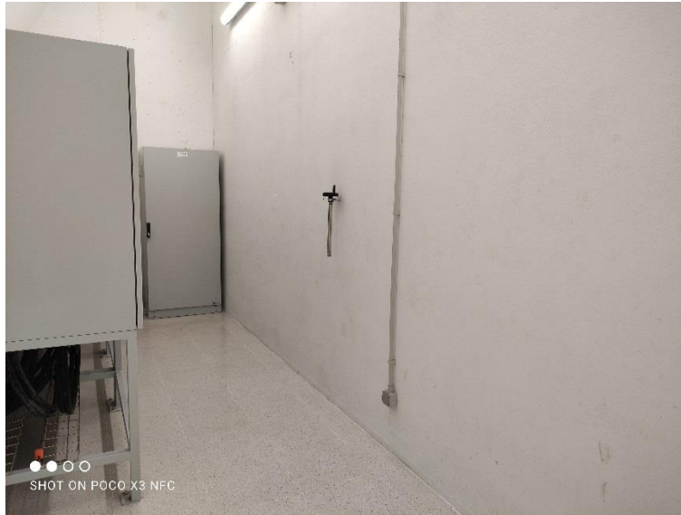
Fotografía 1. Cuarto de seccionamiento de catenaria. Estación de Altza
