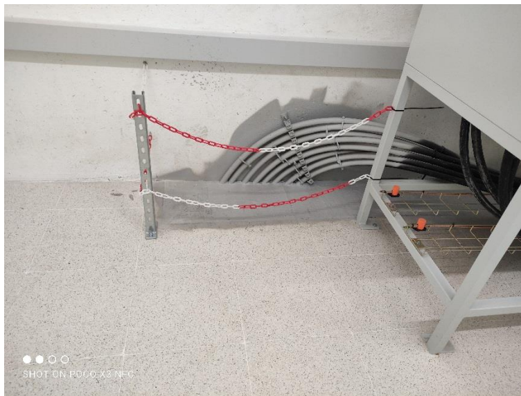
Fotografía 2. Cuarto de seccionamiento de catenaria. Estación de Altza. Tendido de feeders
