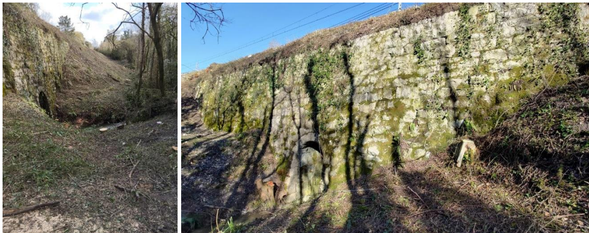
Vista de la boca de aguas arriba (Sureste) de la ODT 72+502 y muro de mampostería de contención de tierras sobre la que se apoya la plataforma ferroviaria de vía única actual. Imagen de la izquierda tomada hacia el Sur (avance de PPKK) y en la imagen derecha hacia el Norte (decrecimiento de PPKK)
