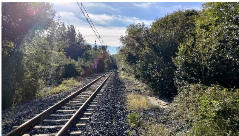
Imagen representativa de la sección tipo de plataforma provista de bermas laterales sin cunetas y sin desmorte ni terraplén (PK 72+465 a PK 72+610)
