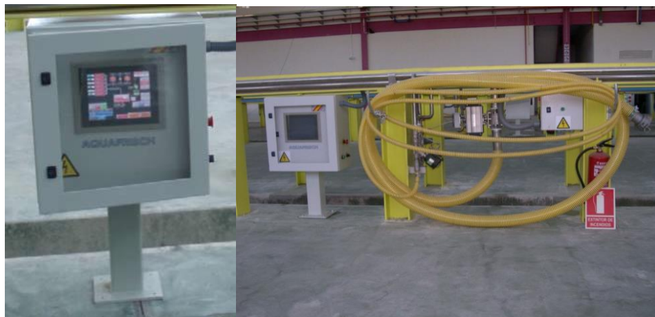
Figura 9. Panel de control de los puntos de módulo de servicio junto a los mismos (SMP)
