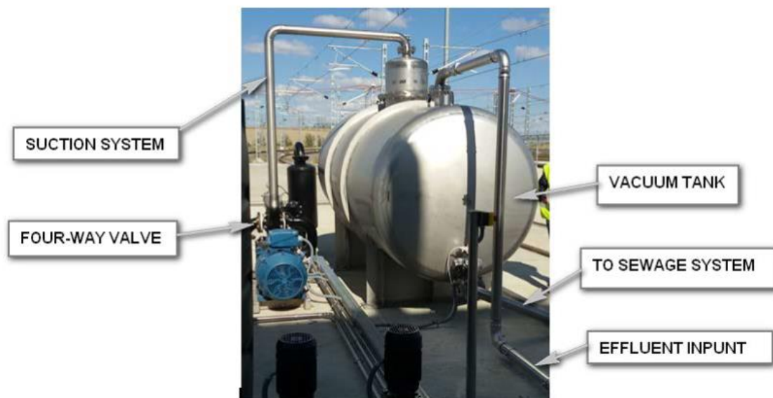
Figura 6. Elementos y conexiones al deposito de recogida
