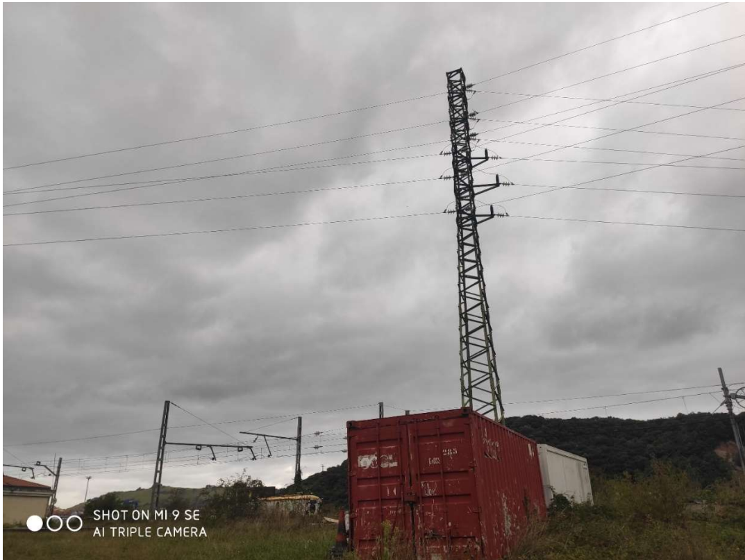
Figura 10. Torreta de celosía a desviar donde llegan dos línea de alta tensión y dos línea de media tensión hacia empresas Lagun Artea y Zoe
