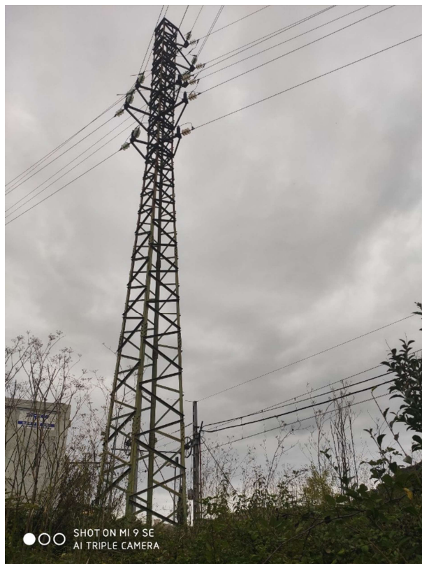
Figura 11. Otra vista de torreta de celosía a desviar donde llegan dos línea de alta tensión y dos línea de media tensión hacia empresas Lagun Artea y Zoe
