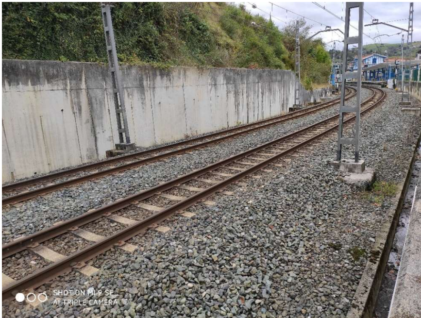
Figura 1. Plataforma de doble vía en balasto frente a edificio de cocheras de autobuses de Euskotren con estación de ferrocarril de Zumaia al fondo.
