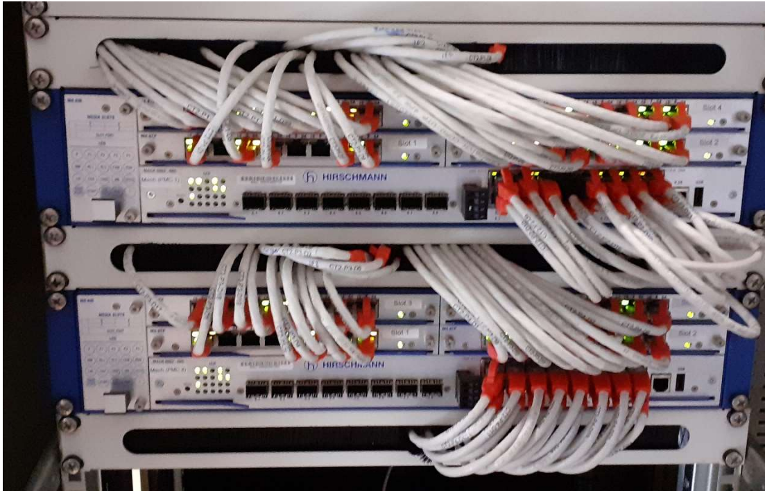
Imagen 8: Conmutadores de Puesto de Mando
