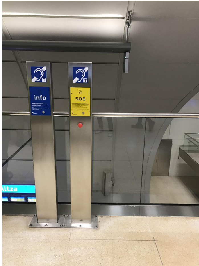
Figura 18: Detalle de interfonos de información y emergencias en la estación de Altza.
