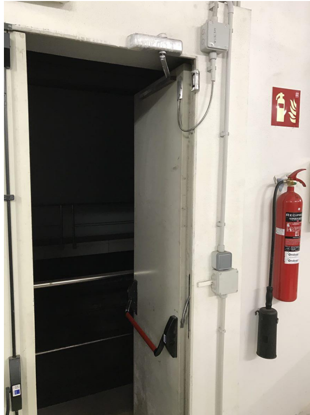
Figura 25: Detalle de puerta de acceso a local técnico en la estación de Herrera
