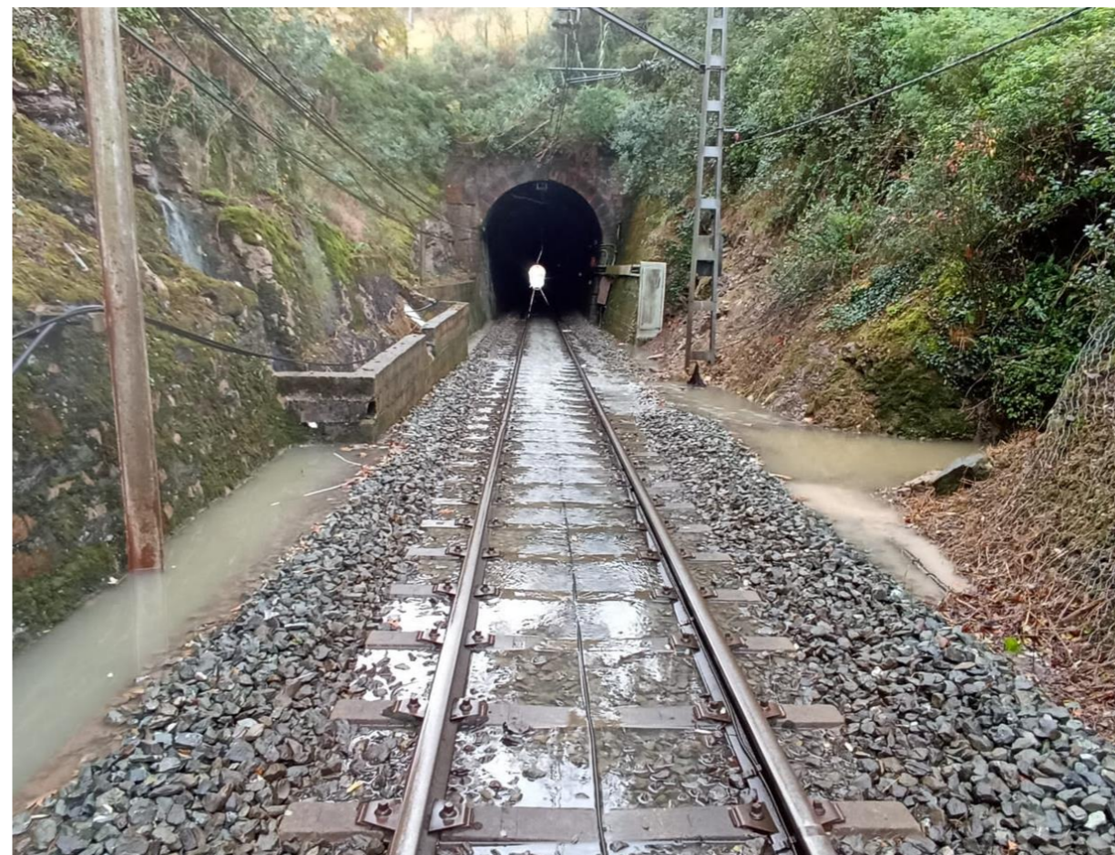
FIGURA 1. INSUFICIENTE EVACUACIÓN DE LLUVIAS EN EL AMBITO DE PROYECTO
