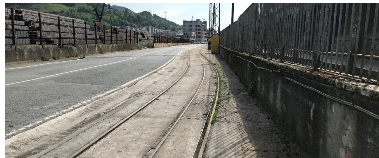
FIGURA 8. TRAZADO EN CURVA Y CONTRACURVA CON GÁLIBO LATERAL INSUFICIENTE
