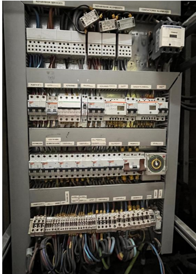
Cuadro eléctrico Baja Tensión del CT-1
