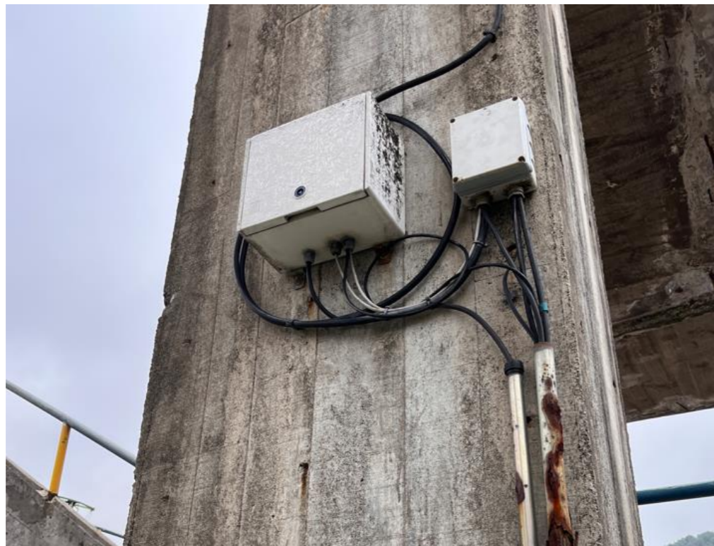
Armario de comunicaciones y caja de conexiones en pasarela peatonal
