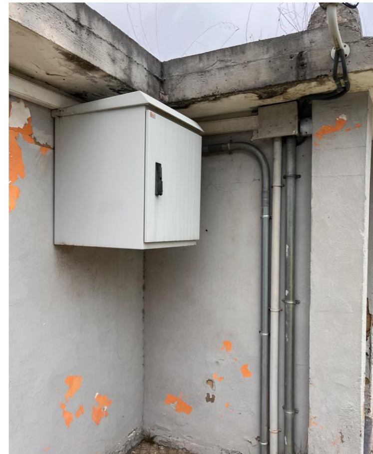
Rack 04, adosado a la fachada del edificio WC de la zona principal de accesos
