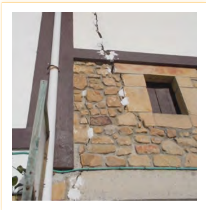
Imagen 26. Grietas reparadas en la fachada de una vivienda que han vuelto a abrirse.
