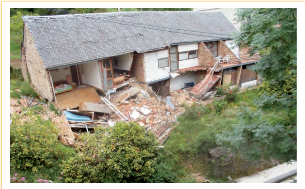
Imagen 1. Daños producidos en una vivienda afectada por un deslizamiento.
