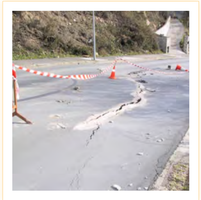
Imagen 29. Grietas en una carretera asfaltada. Se aprecia que las grietas han sido reparadas y se han abierto nuevamente.
