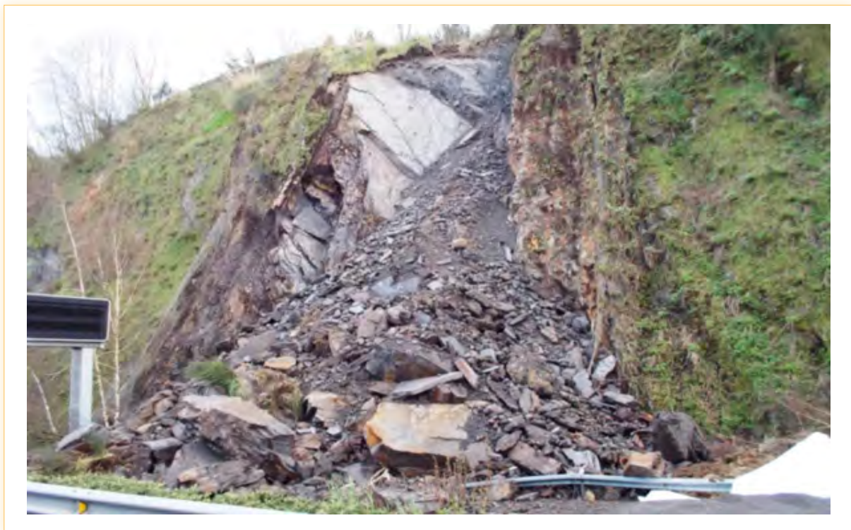
Imagen 14. Avalancha de rocas afectando a una carretera.
