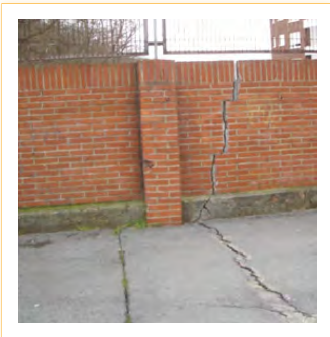
Imagen 30. Grietas en un pavimento y en un muro de ladrillos.
