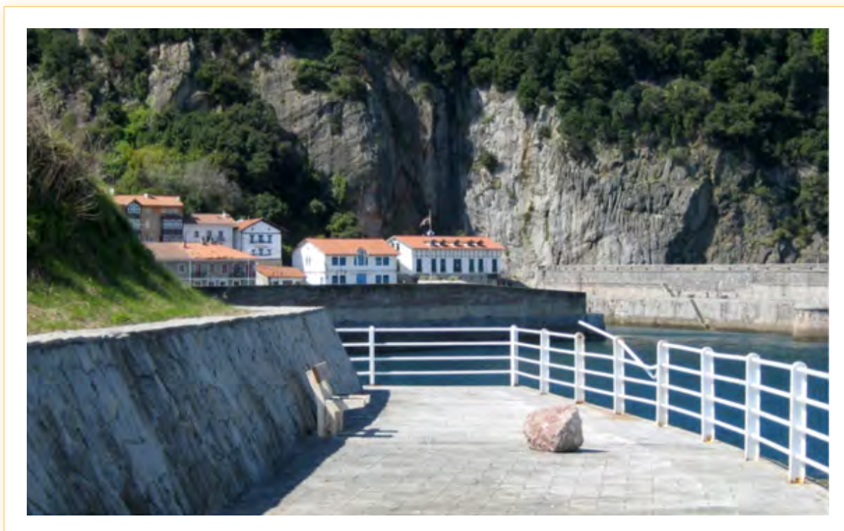
Imagen 10. Desprendimiento de bloque rocoso que ha rebotado y dañado la barandilla en una zona de tránsito sin riesgo aparente para transeúntes.
