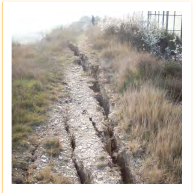
Imagen 24. Escarpe y grietas de tracción en la parte alta de una ladera.
