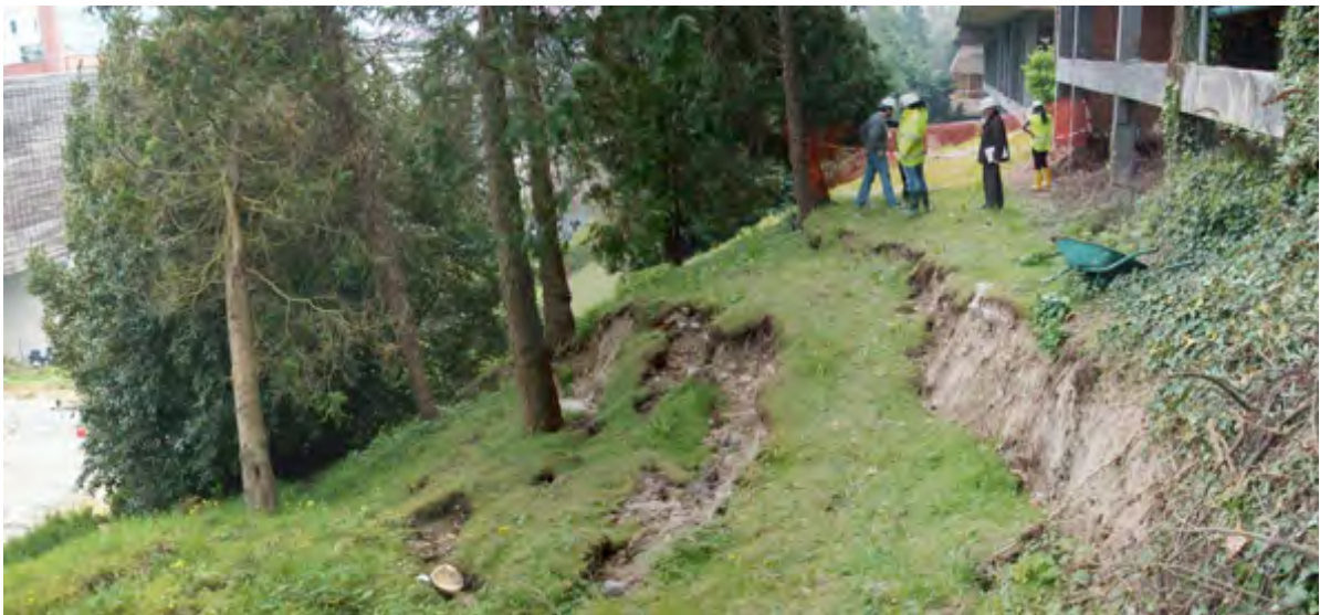
Imagen 2. Deslizamiento afectando a rellenos en una ladera cercana a la cimentación de un bloque de viviendas.
