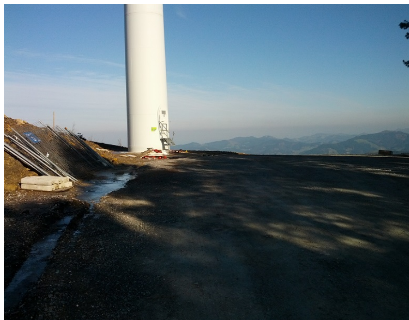
Foto 12: Residuos pendientes de ser retirados junto al aerogenerador 15 (28/11/2013)
