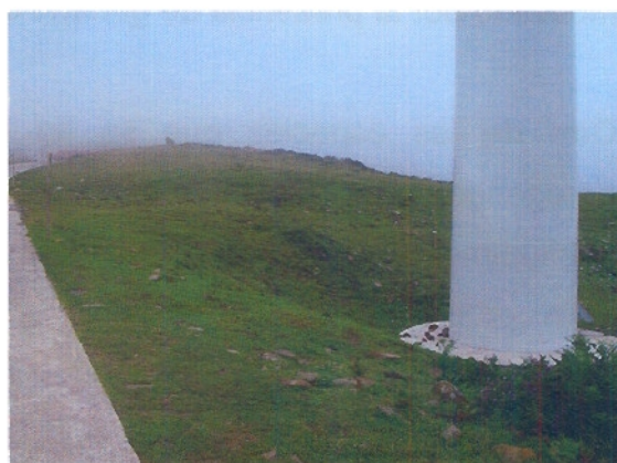
Estado de la plataforma del aerogenerador nº 37 de la fase II del parque eólico de Oiz.
