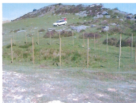
Depresión Inundable contigua al aerogenerador nº 39 de la fase II del parque eólico de Oiz balizada de cara a iniciar las obras de construcción de la fase II del parque eólico de Oiz.
