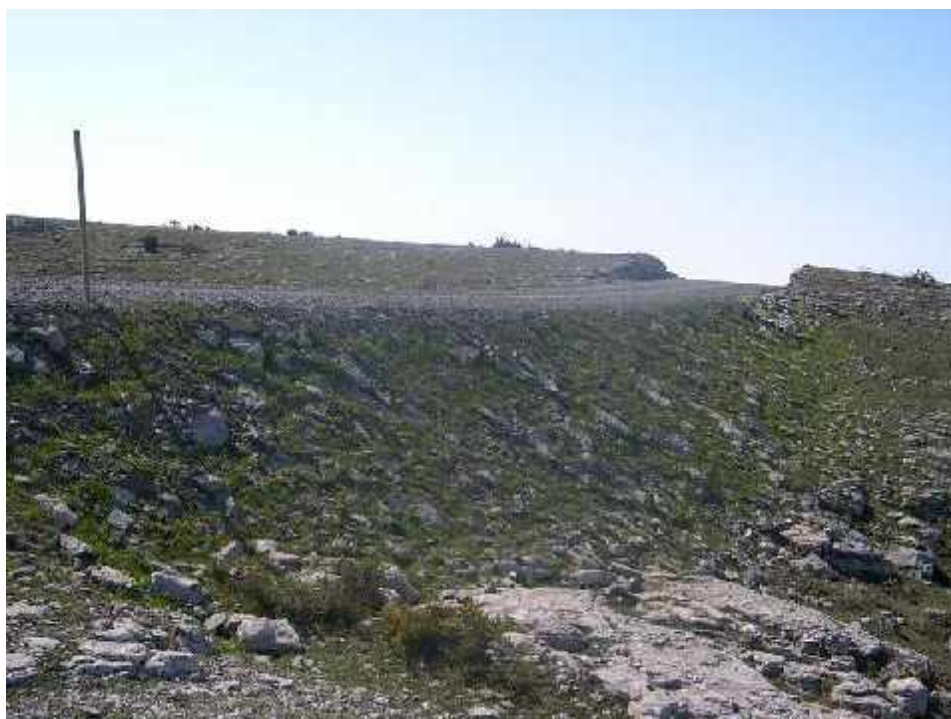
Situación actual tras la restauración y revegetación del mismo talud del pedraplén visto desde el extremo opuesto.
