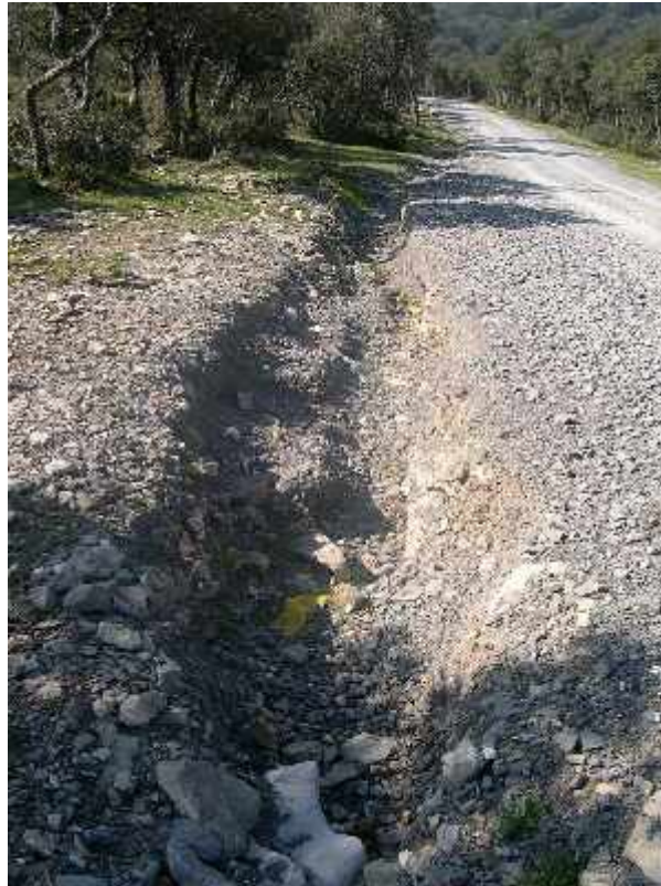
Erosión provocada por la lluvia en algunos tramos de cuneta
