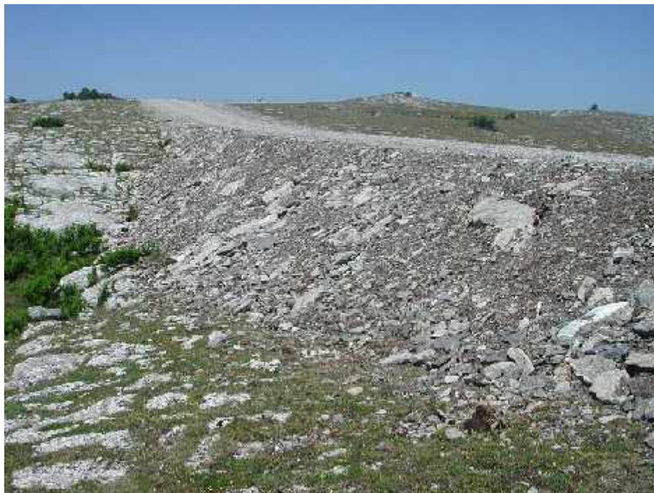
Fotografía inicial del pedraplén que hubo que realizar en los caminos internos del parque para poder llegar hasta la posición nº 23.
