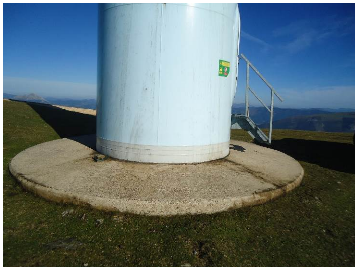
Foto 1: pérdida de aceite en el aerogenerador 35 (20/11/2014)
