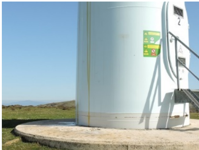
Foto 3: mancha de aceite en el aerogenerador 2 (10/04/2014)
