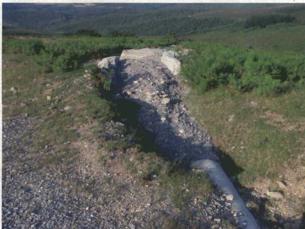
Material arrastrado por el agua de escorrentía retenido por los deflectores reduciendo el efecto erosivo provocado por el agua y los materiales.
