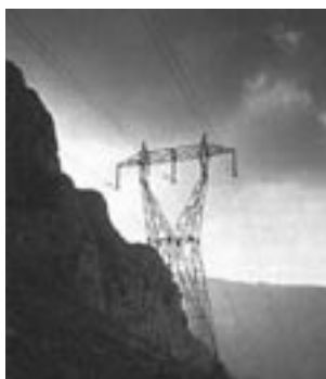
4. Elektrizitatea garraiatzeko sarea
